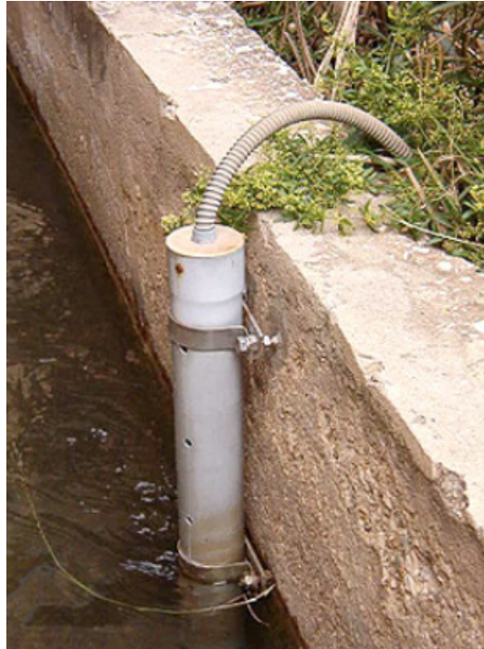
Figura 7. Sensor Piezorrestivo instalado en acequia Fuente CH Segura (2020)
