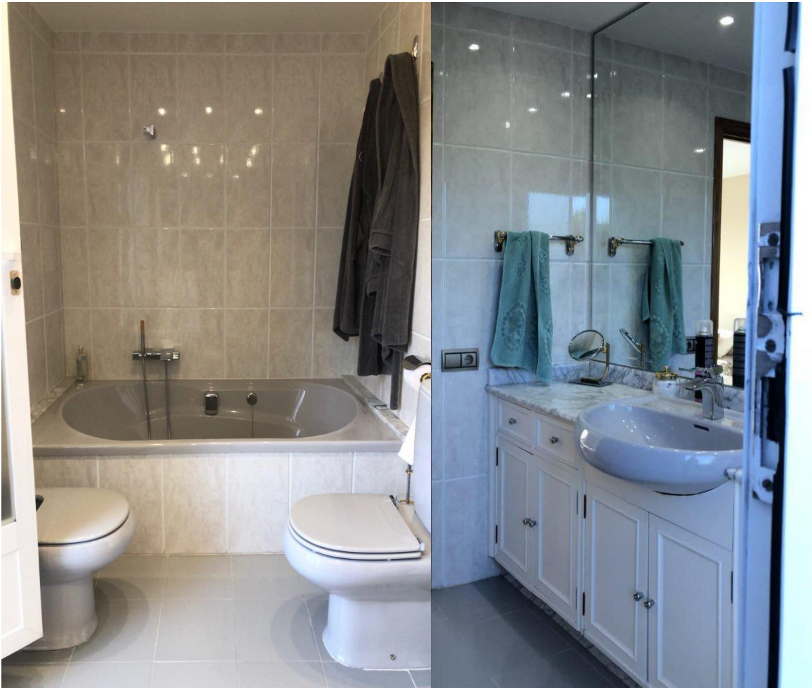
Fotografías 7 y 8. Estado inicial del baño.
