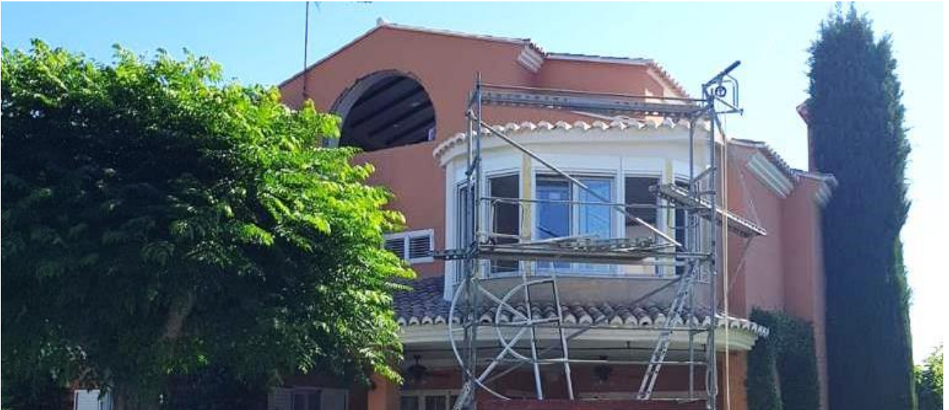
Fotografía 3. Estado exterior con los ventanales de la buhardilla eliminados.
