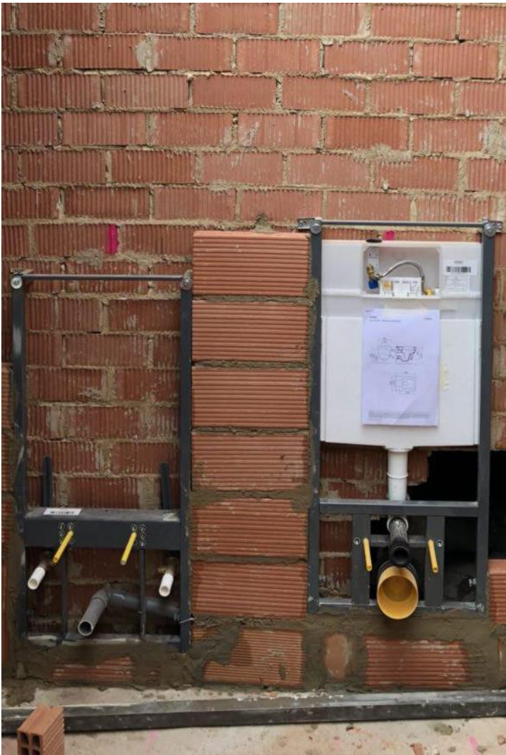
Fotografía 19. Bastidores empotrados para sanitarios suspendidos.
