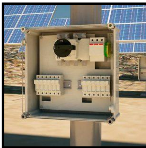
Cajas de conexiones en Strings
