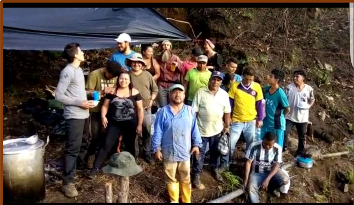
Foto: en terreno arreglando un acueducto comunitario con el equipo y líderes y participantes locales del barrio Bello Oriente, durante los primeros días de observación participante.
