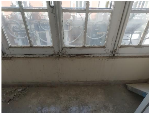
Ilustración 29: Imagen de carpintería de fachada principal para restaurar. Fuente:Propia
