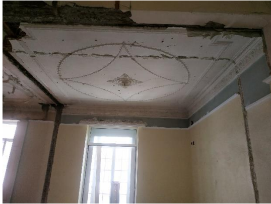
Ilustración 34: Falso techo en mal estado para demoler. Fuente: Propia
