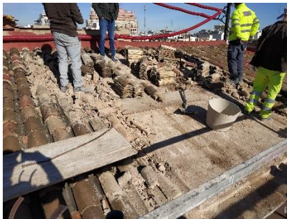
Ilustración 20: Retirada de la teja existente y acopio de la misma. Fuente: Propia
