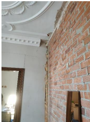
Ilustración 35: Moldura en mal estado. Fuente: Propia
