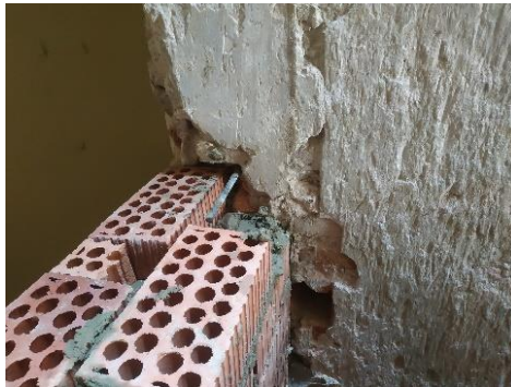
Ilustración 19: Conexión del nuevo tabique con la caja de escalera existente. Fuente: Propia
