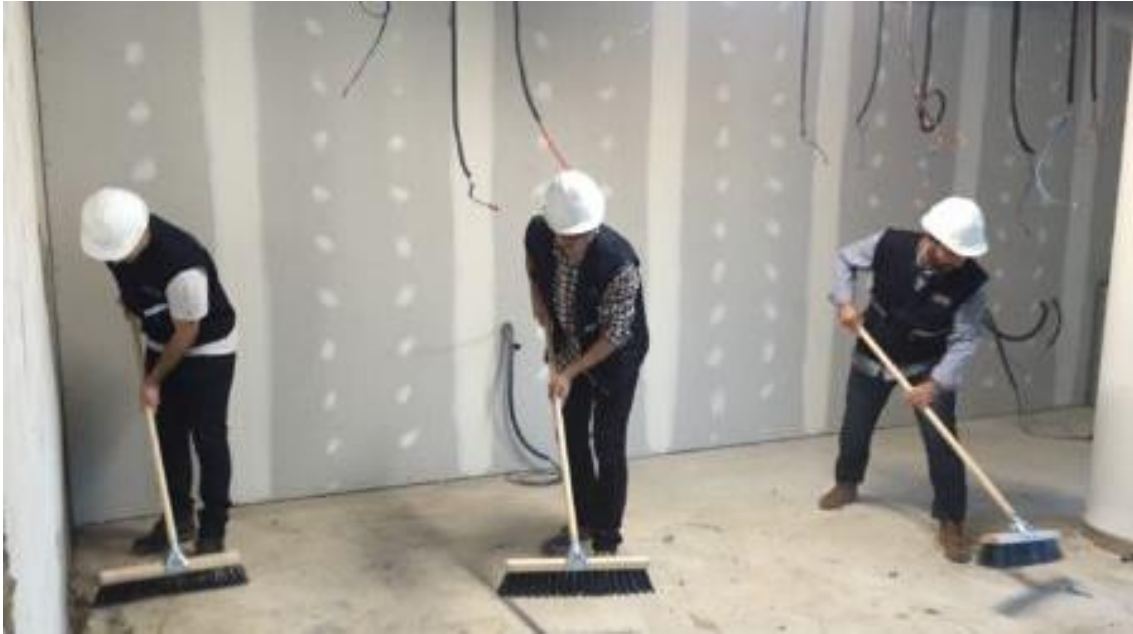
Ilustración 22, Limpieza en obra, y colocado de cartel. Fuente: extraído de google imagen
