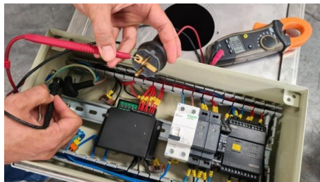
IMÁGEN 80: ENSAYO AISLAMIENTO TT-BORNES
