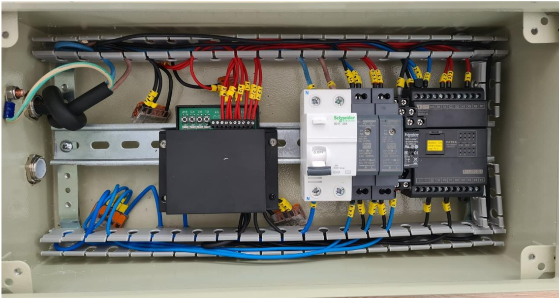
IMÁGEN 50: CABLEADO INTERNO
