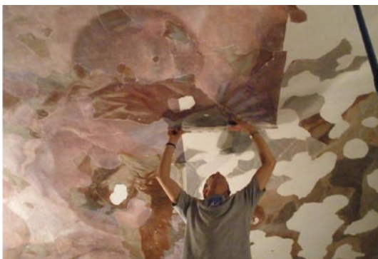
Fig.3.3 Proceso de reintegración de la bóveda de la Iglesia de los Santos Juanes
