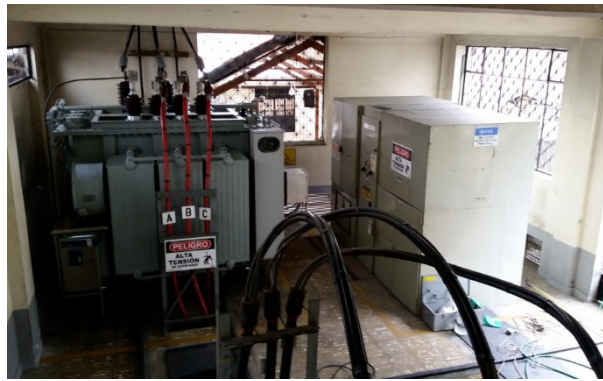
Imagen 5.12 Transformador No. 1 de la Subestación 1 de la EERCS [66]
