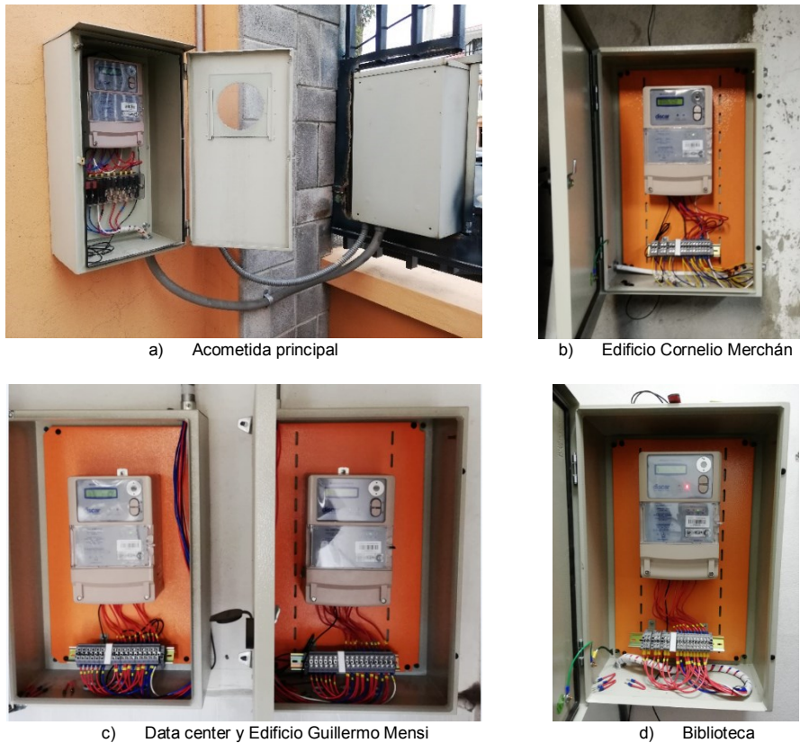
Imagen 3.12 Medidores instalados en la de la UPS Sede Cuenca
