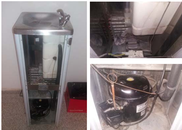
Figura 1 Instalación térmica objeto central de la aplicación de AR.
