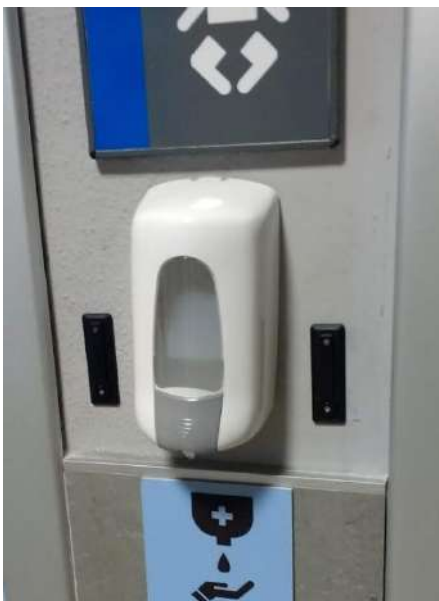
Fig. 72 Dispensador manual baños
