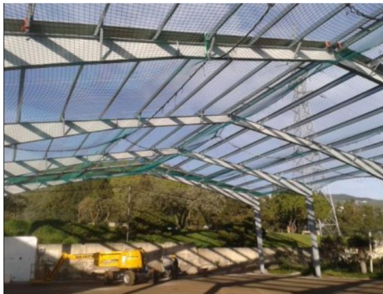
Ilustración 26 Estructura metálica y elementos de seguridad
