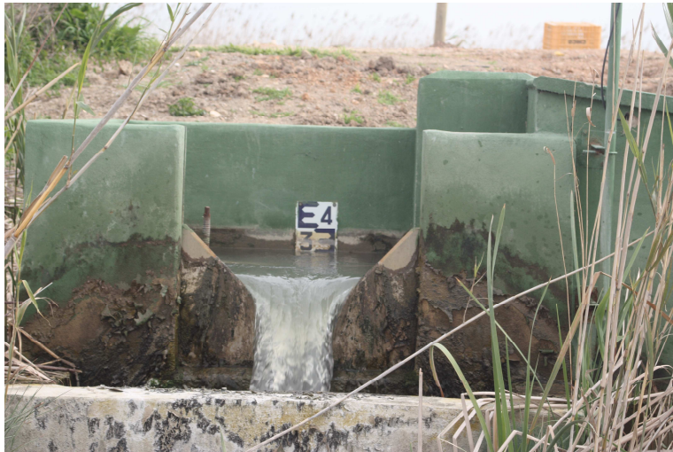
Figura 29: Arqueta de entrada de agua, al sistema de humedales, procedente del Barranco del Poyo.
