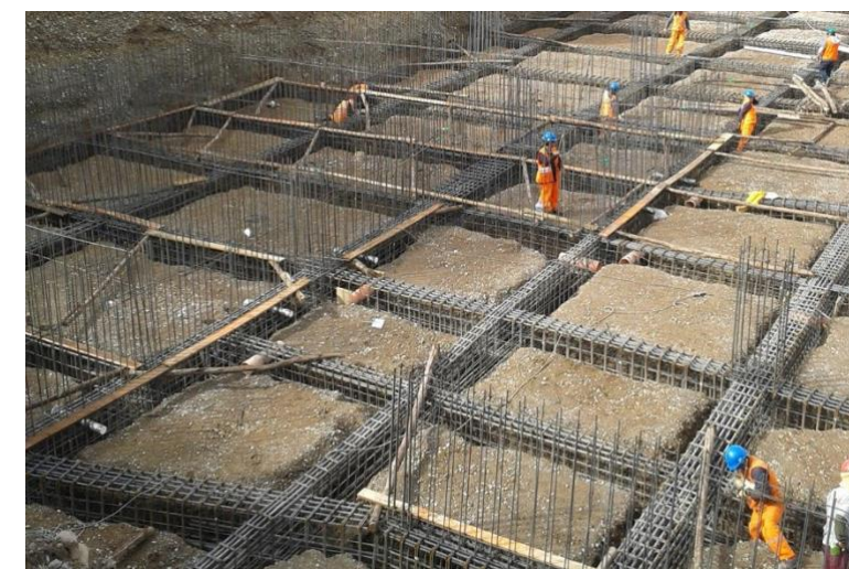
Figura 18. Detalle del armado de un emparrillado de cimentación. Fuente: YEPES, V. (2016). Procedimientos de construcción de cimentaciones y estructuras de contención. Editorial Universitat Politècnica de València.
