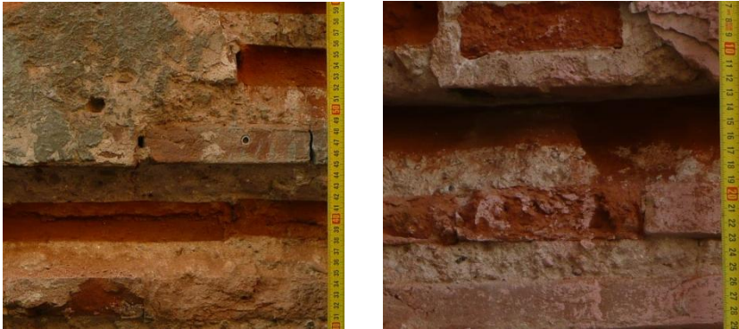
FIG. 106 Detalles de erosiones en ladrillos, fichas Cf39 y Cf42 (CRISTINI)
