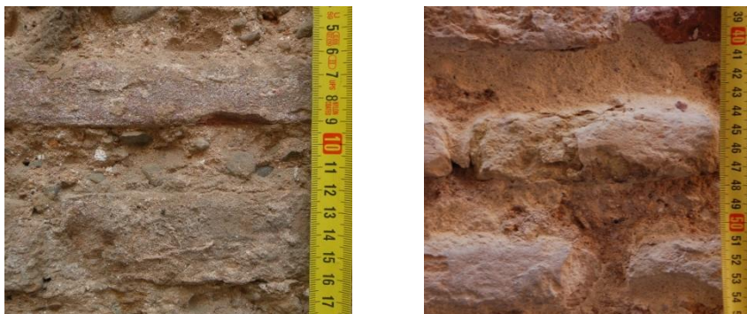
FIG. 109 Detalles de descamación en ladrillos, fichas Xc78 y Ma82 (CRISTINI)
