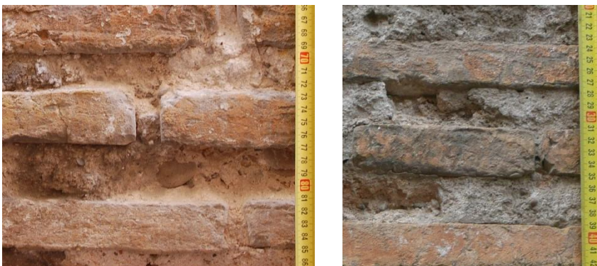
FIG. 107 Detalles de micro fisuración en ladrillos, fichas Ma91 y Cg01/b (CRISTINI)
