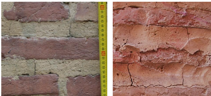
FIG. 111 Detalles de micro fisuración de las juntas, fichas Ce71 y Me52 (CRISTINI)
