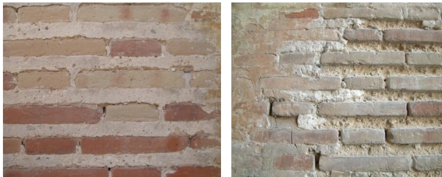
FIG. 120 Detalle de limpieza, zonas con excesiva proyección mecánica, viviendas de C/Roger de Flor nº39, Valencia (CRISTINI)
