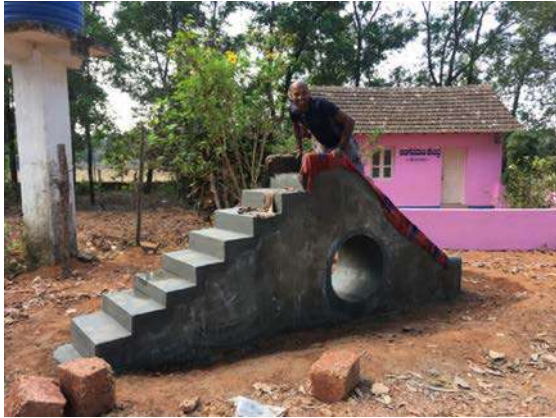
Ilustración 147: Acabado de cemento en tobogán. Fuente: propia
