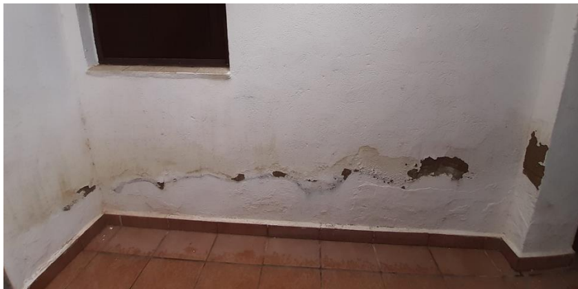
Figura 20. Humedades por capilaridad pared exterior a dormitorio 2
