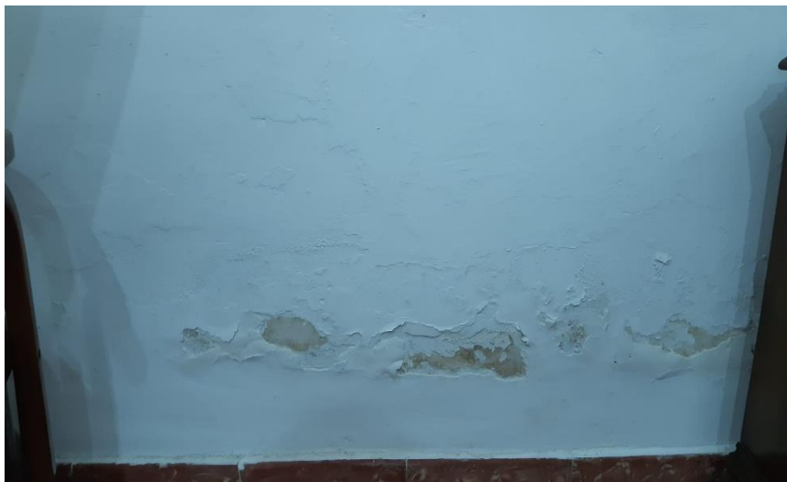
Figura 21. Humedades por capilaridad pared interior en dormitorio 2
