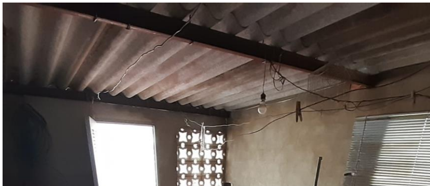
Figura 22. Cubierta de fibrocemento con amianto
