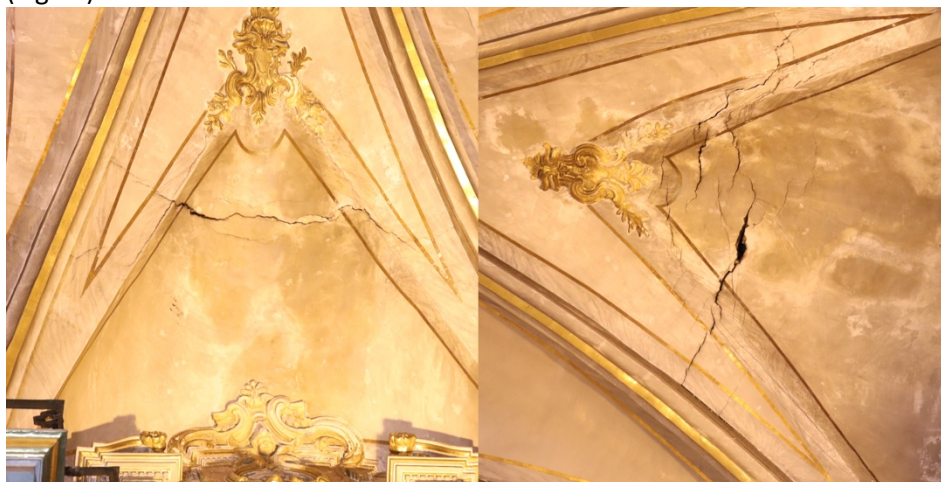
Figura 30. Detalle daños estructurales
