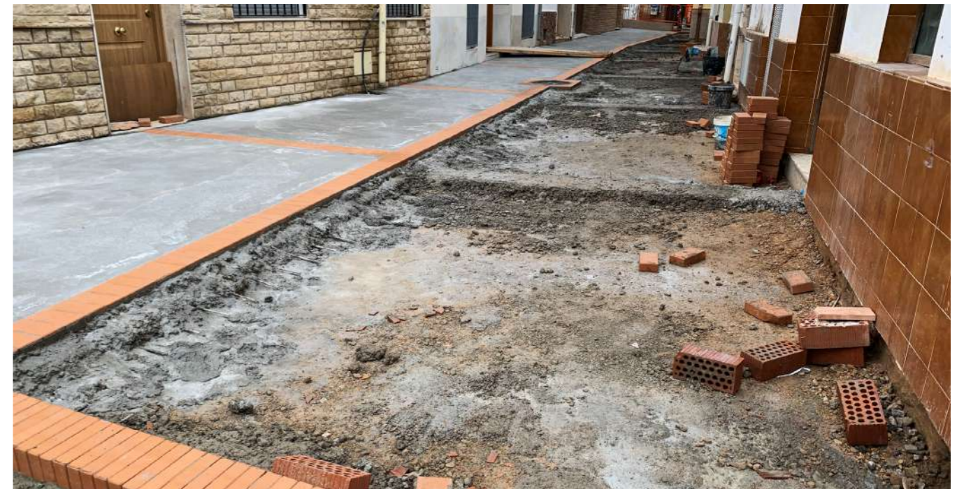
img.91 Intervenciones recientes realizadas por el Ayuntamiento de Gestalgar 1. Pavimento de piedra con juntas que permiten el crecimiento de vegetación, ribera del Turia | 2. Renovación del pavimento de la calle Trinquete sobre la acequia madre [Fotografías propias, 2020]
