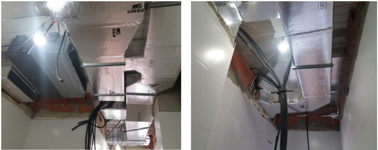
Figura 28_ Conductos de instalaciones
