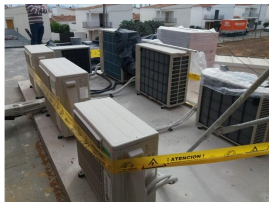
Figura 22_ Zona donde se ubican las instalaciones de los equipos color rojo y fotografía de estas
