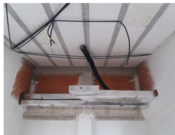
Figura 29_ Conductos de instalaciones y registros de salida
