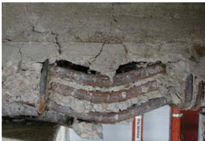
Figure 5.14: Plastic hinges. Source: Procedura numerico-sperimentale della fase di riallineamento delle travi dell'impalcato del 26° piano del grattacielo Pirelli a Milano [4].
