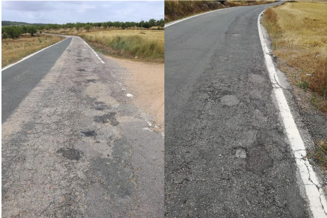
Figura 7: Desperfectos del firme en el tramo de la carretera CV-35 sobre el PK 7+400 (Fuente: Elaboración propia)
