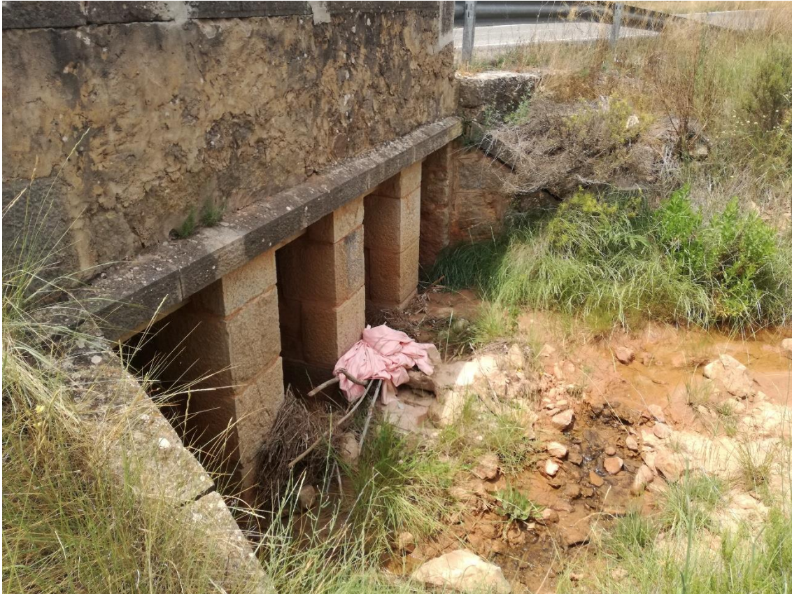
Figura 21: Desechos acumulados aguas arriba de una ODT. (Fuente: Elaboración propia)
