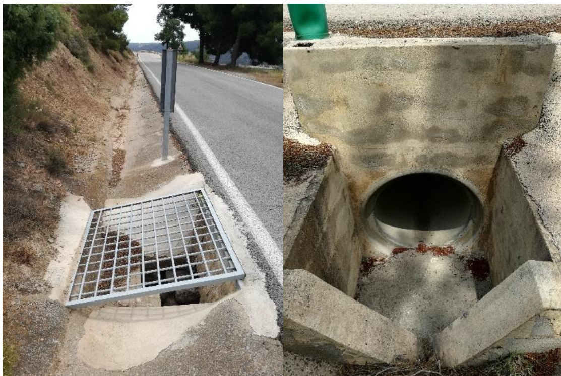
Figura 35: Cuneta "tipo V" revestida de hormigón y colector transversal existente actualmente. (Fuente: Elaboración propia.)
