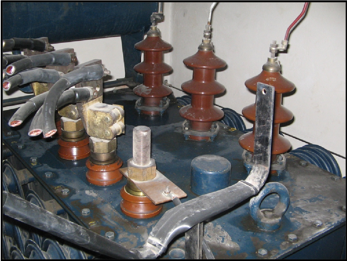
Fotografía 2. Transformadores con los cables sustraídos.
