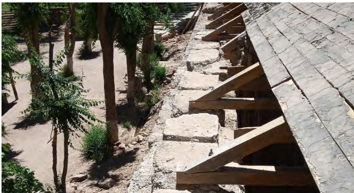
Proceso de retiro de zuncho de hormigón armado sobre muro histórico de adobe. Fotografía: autores Process of removal of reinforced concrete beam on historic adobe wall. Photography: authors
