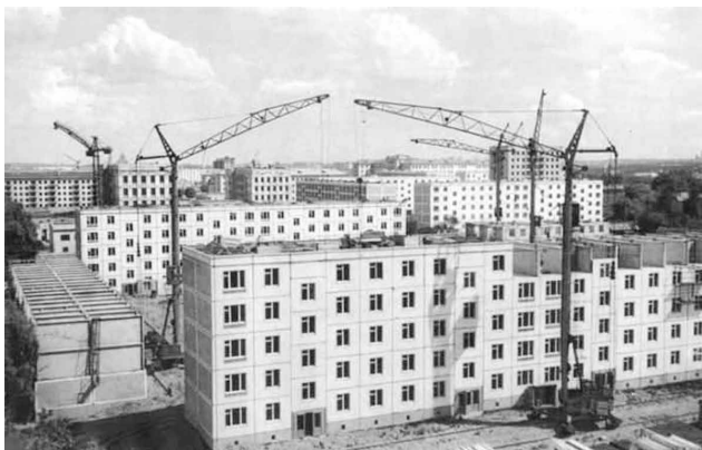
Las edificación de los primeros conjuntos de vivienda "Khrushchovky". La tipificación que llegó a todos los rincones de espacio soviético. Recuperado de https://ossr.ru/wp-content/uploads/2019/04/11-5.jpg
