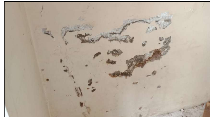
Imagen 58: Humedades en parte inferior de paredes. Fuente: Elaboración propia
