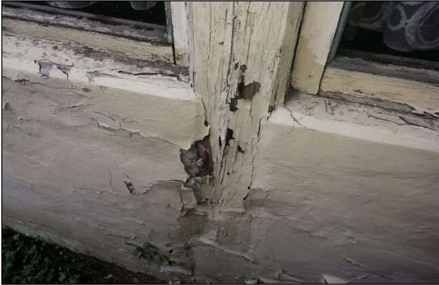
Imagen 66: Columna de madera fisurada y con presencia de humedad. Fuente: Elaboración propia
