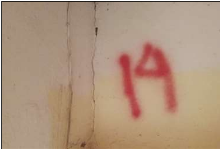
Imagen 48: Fisuras en paredes. Fuente: Elaboración propia
