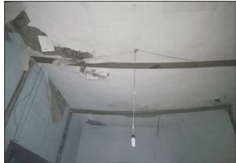
Imagen 41: Falso techo "chocoto". Fuente: Elaboración propia
