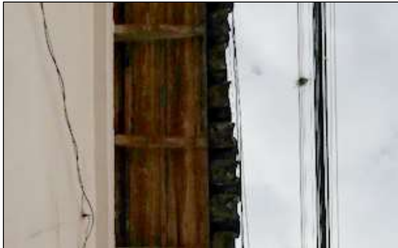
Imagen 69: Estado actual elementos en aleros. Fuente: Elaboración propia
