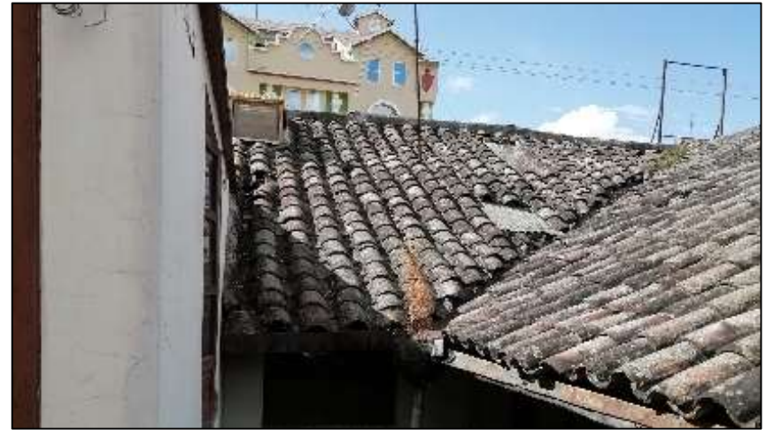
Imagen 65: Cumbre de cubierta deformada. Fuente: Elaboración propia
