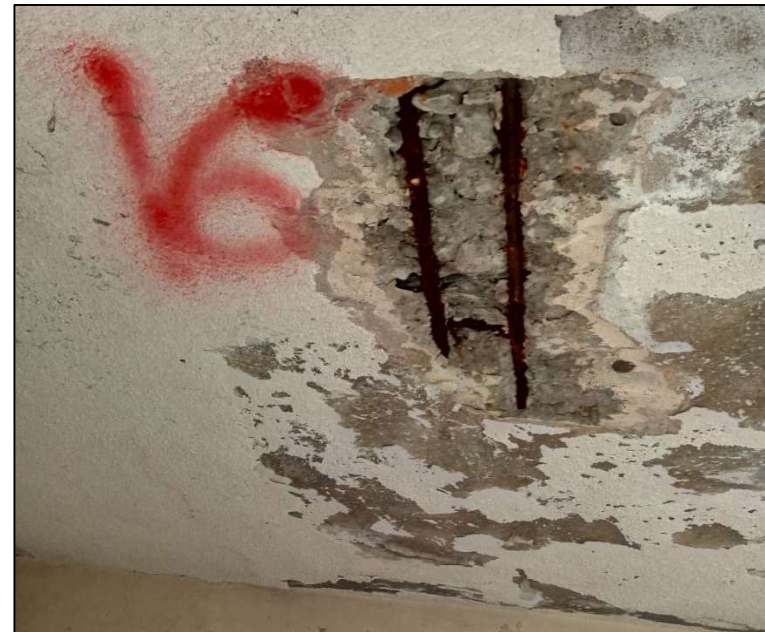
Imagen 55: Varillas oxidadas. Fuente: Elaboración propia
