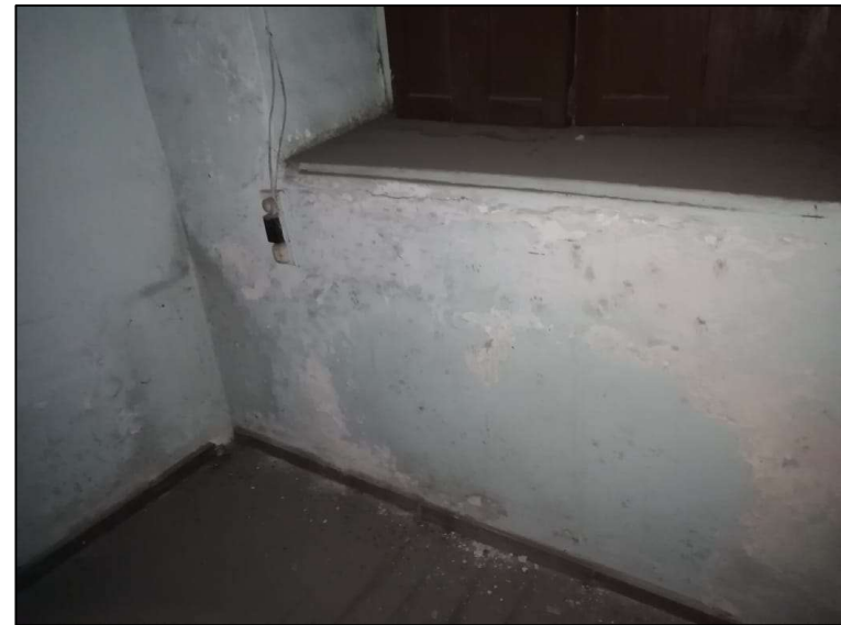
Imagen 47: Eflorescencias en paredes. Fuente: Elaboración propia
