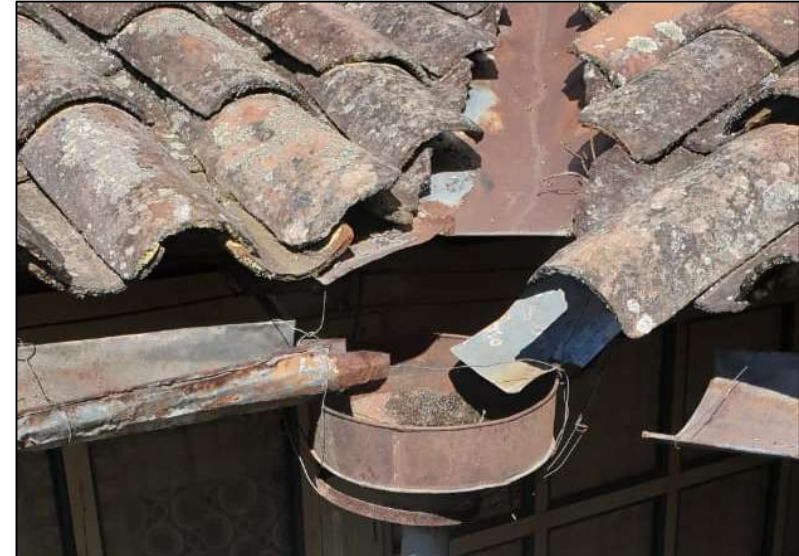
Imagen 67: Canalones oxidados. Fuente: Elaboración propia
