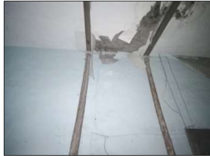
Imagen 49: Fisuras en paredes. Fuente: Elaboración propia
