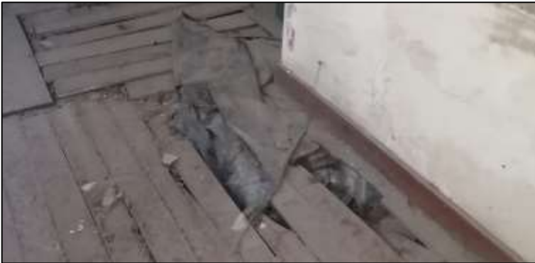
Imagen 50: Piso levantado y roto. Fuente: Elaboración propia
