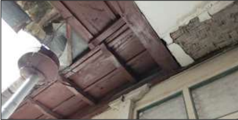
Imagen 68: Estado actual elementos en aleros. Fuente: Elaboración propia
