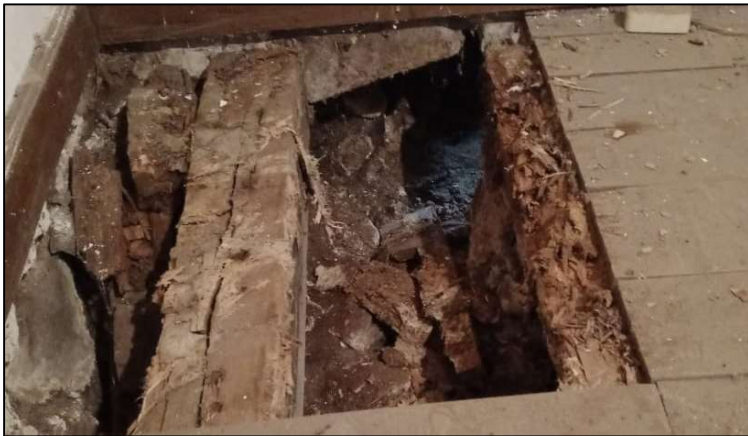
Imagen 51: Piso levantado y roto. Fuente: Elaboración propia
