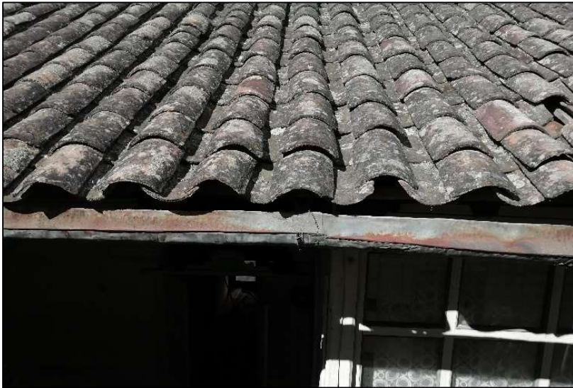
Imagen 64: Tejas originales en mal estado. Fuente: Elaboración propia
