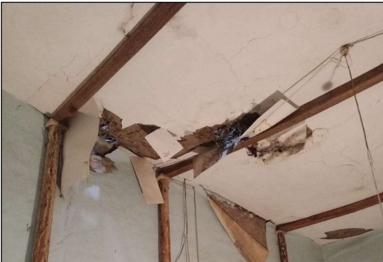
Imagen 59: Refuerzos en falso techo. Fuente: Elaboración propia
