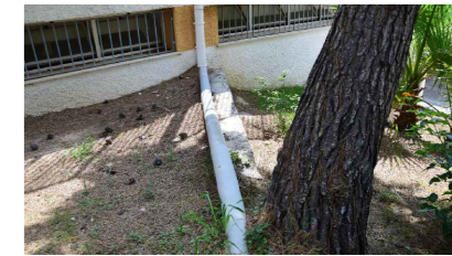
20 · Instalaciones vistas que atraviesan la zona verde no pisable.
