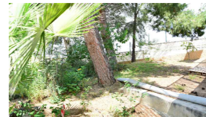
21 · Instalaciones vistas que atraviesan la zona verde no pisable.
