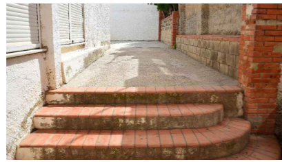
42 · Desnivel existente entre zona 7 y zona exterior en desuso.
