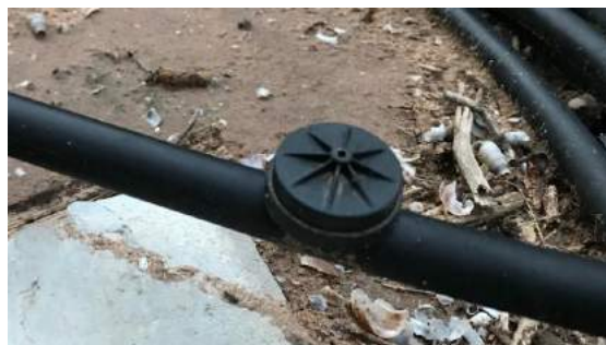
Figura 3.6: Detalle del gotero en la tubería.
