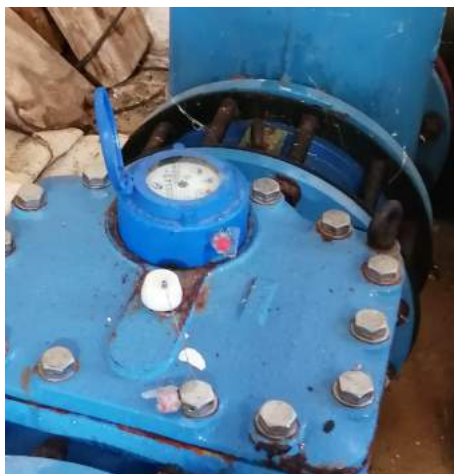
Figura 4.19: Contador de agua.
