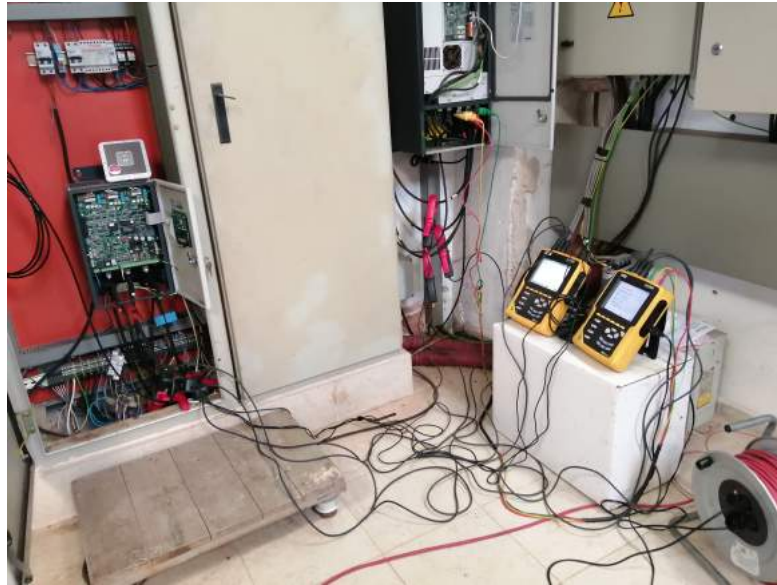
Figura 4.15: Detalle de la instalación con los analizadores de red conectados al cuadro eléctrico.
