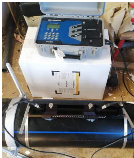
Figura 4.18: Registro de caudales en el cabezal con un caudalímetro ultrasonido.
