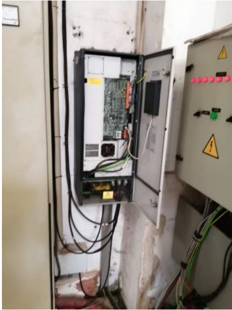
Figura 4.12: Variador de frecuencia.
