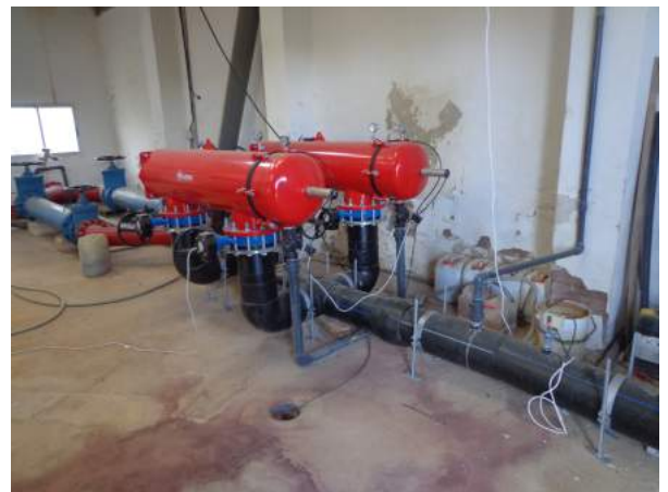
Figura 4.6: Sistema de Filtración.
