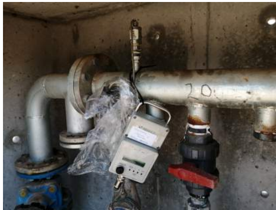
Figura 4.17: Ejemplo de instalación de un transductor de presión en un hidrante.
