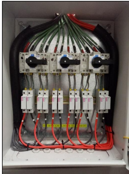
Imagen 7: Caja de protecciones de continua
