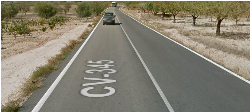
Figura 16. Ejemplo de NO obra de drenaje longitudinal. Fuente, Google Maps
