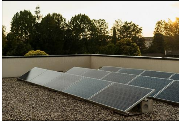
Figura 39. Instalación típica de paneles fotovoltaicos en una cubierta.
