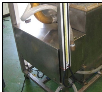
Figura 3.50 Depósito de agua
