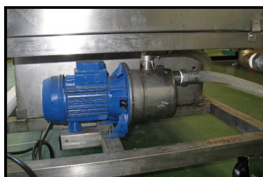
Figura 3.51 Bomba de agua del circuito de refrigeración
