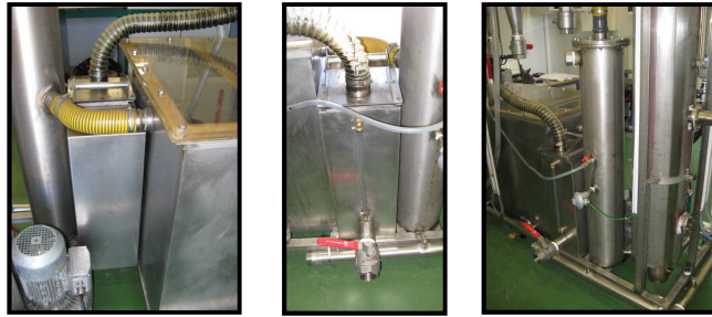
Figura 3.44 Depósito de alquitranes
