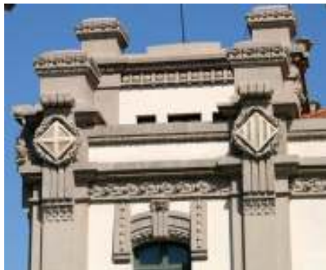
Fig. nº 187 y 188.- Vista remates fachada Lat. Derecha. E. de Valencia y de cuerpo lat. E. Barcelona-Nord. Archivo propio (2008-2010).
