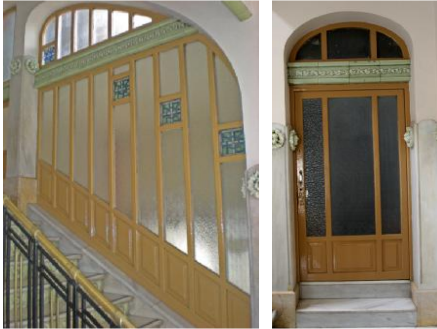
Fig. nº 402 y 403.- Detalle de mampara y de puerta. Núcleo escaleras torreón izquierdo. (A. Propio - 2011).
