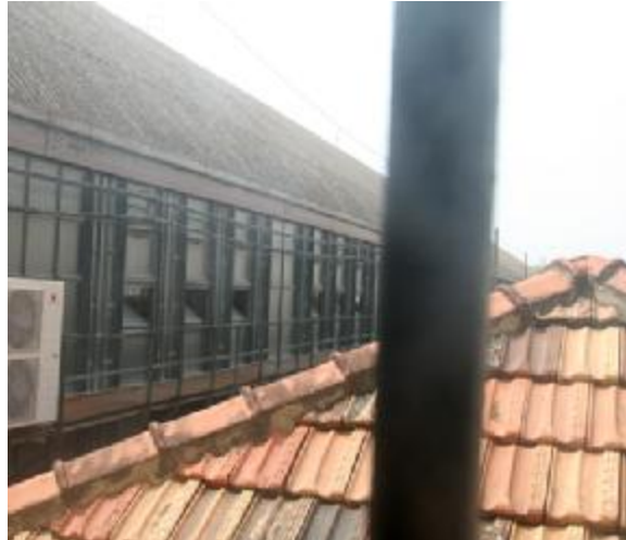
Fig. nº 599.- Detalle del encuentro de una de las cubiertas inclinadas con el ventanal lateral de la cubierta metálica. Alas laterales del edificio de viajeros. E. de Valencia. (A. Propio 2011).
