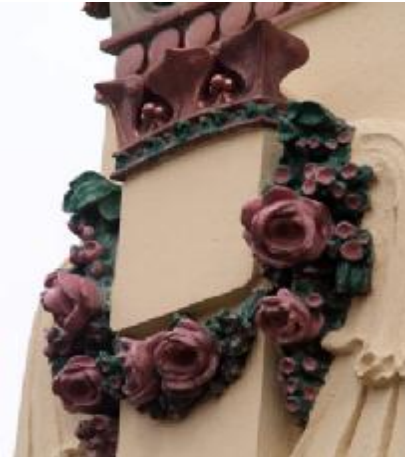
Fig. nº 88.- Detalle existente en el remate torreón. (Recuadro rojo). F. ppal. A. propio (2011).
