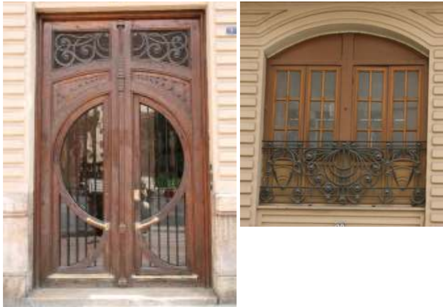
Fig. nº 21 y 22.- Vista de una de las puertas de acceso. Detalle de la barandilla de uno de los huecos del cuerpo basamental. A. Propio (2009).
