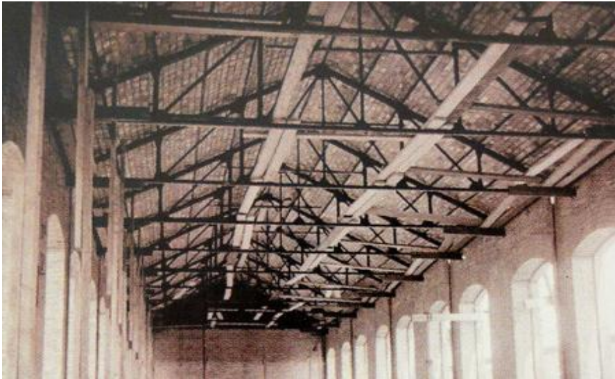
ig. nº 60.- Cerchas originales de cubierta y entrevigado. Muelles cubiertos. E. de Valencia. "La mirada de l'arquitecte".
