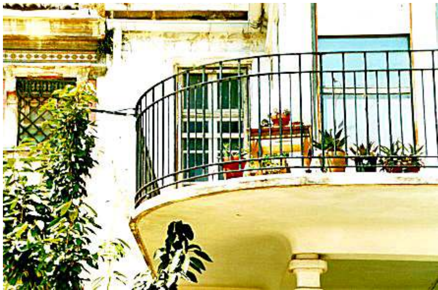
Fig. nº 107 y 108.- Detalle del remate y de la barandilla de pl. 1ª. Vivienda unifamiliar Eugenia Viñes,95. Reg. De arq. SXX. CV.
