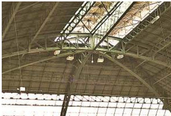
Fig. nº 34.- Vista construcción bóveda. E. de Valencia. "Demetrio Ribes". I. Aguilar. Fig. nº 35.- Detalle bóveda en rincón de claustro. E. de Valencia. A. Propio (2011).
