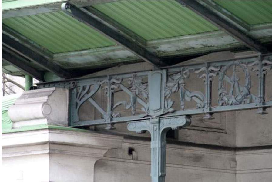
Fig. nº 357.- Detalle de apoyo y viga pórtico. E. de Burgasse Stadthalle. A. propio (2008).
