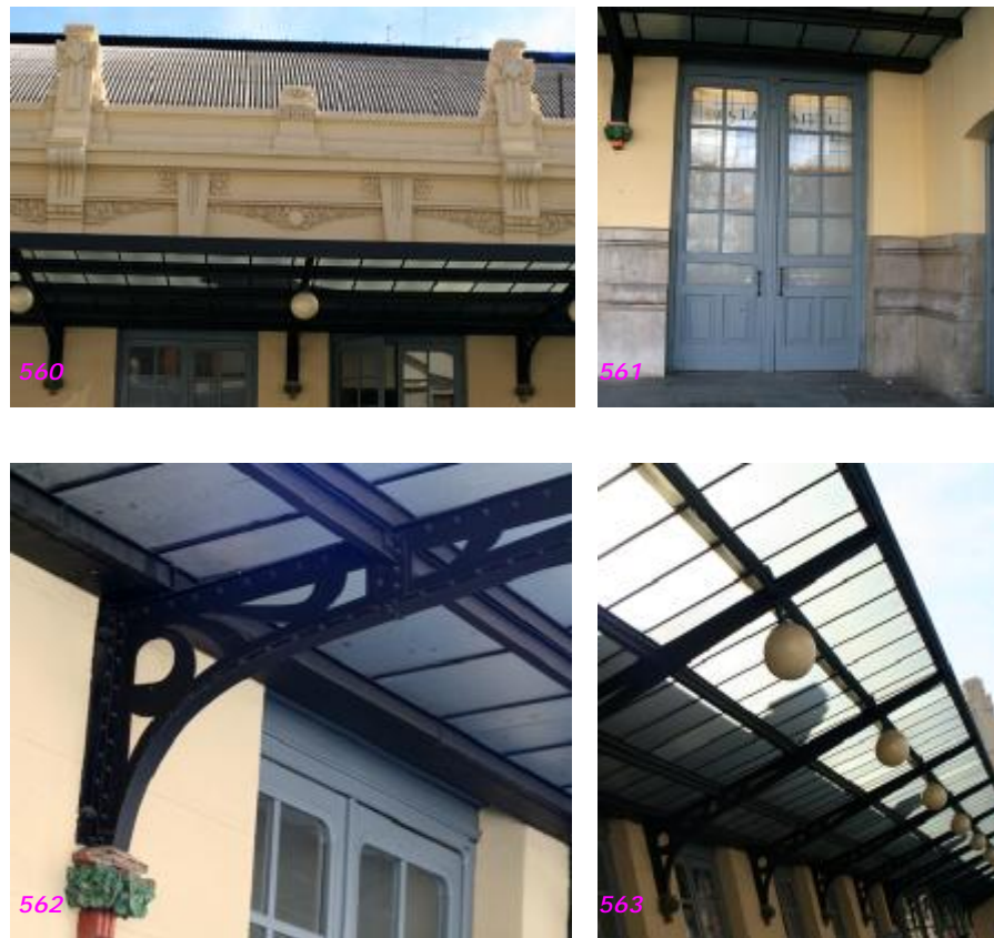
Fig. nº 560 a 563.- Vistas y detalles de marquesina fachada calle Bailén. Estación de Valencia. (Archivo propio 2007-2011).
