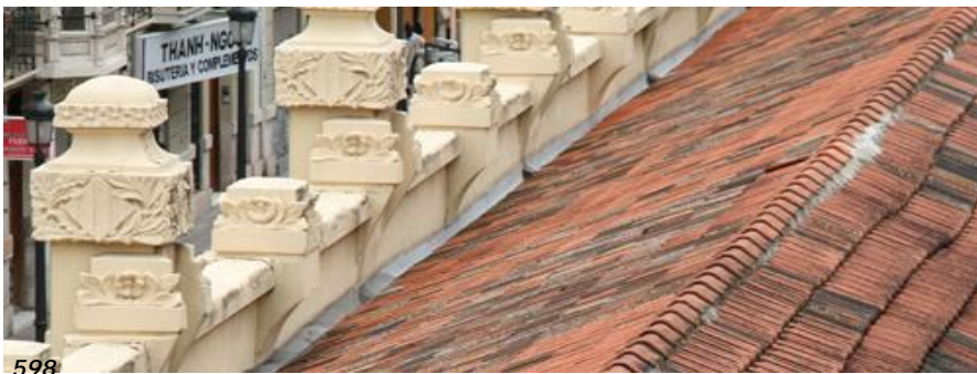
Fig. nº 596 a 598.- Detalles de tejado. Alas laterales del edificio de viajeros. Estación de Valencia. (A. Propio 2007-2011).
