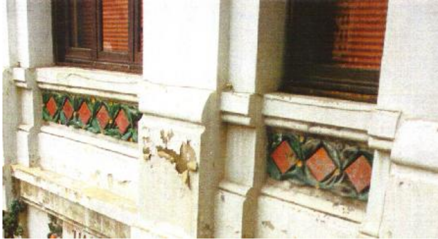
Fig. n° 245.- Vista de la fachada principal antes de su reparación. R. Moreno Tomás (2005).
