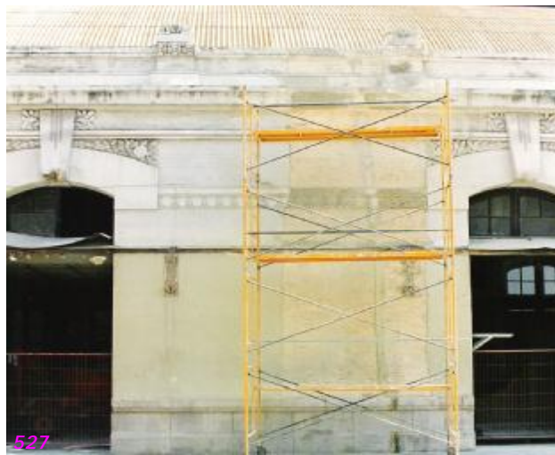
Fig. nº 525 a 527.- Detalles patología e intervención de fachadas. E. de Valencia. R. Moreno Tomás (2005).
