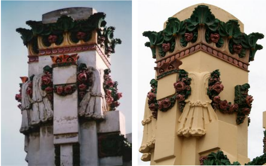
Fig. nº 522.- Detalle de pináculo antes de la reparación de fachadas. Estación de Valencia. R. Moreno Tomás (2005).
