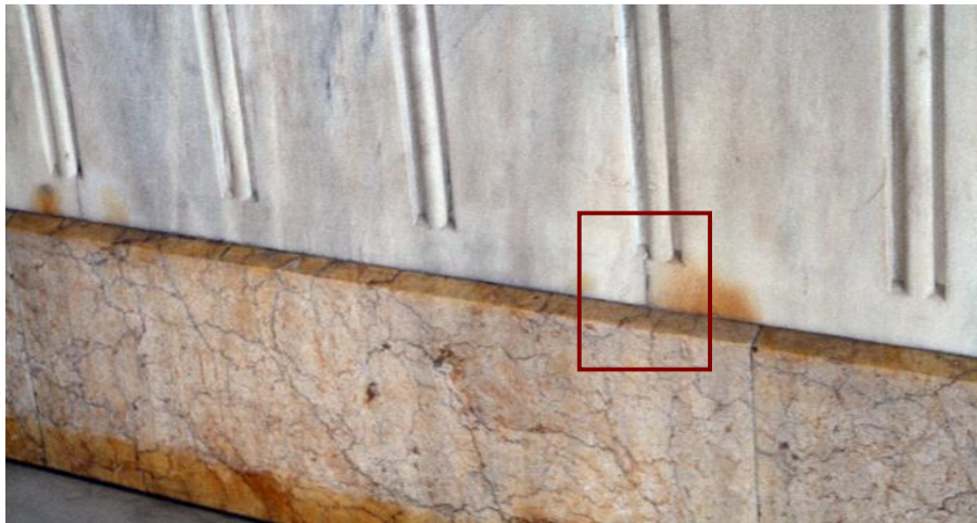
Fig. n° 397.- Detalle juntas zócalo descansillos ppales. Núcleo escaleras torreón izquierdo. (A. Propio - 2011).
