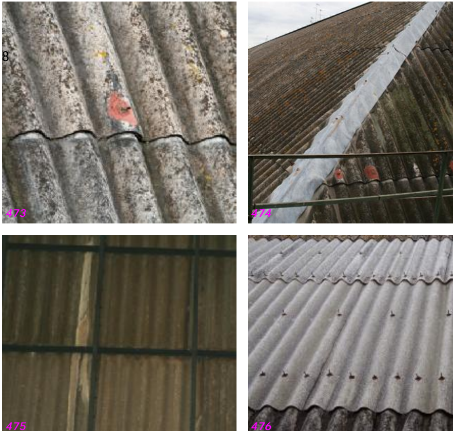
Fig. nº 473 a 476.- Detalles varios de mat. Revestimiento bóveda. Estación de Valencia. (A. Propio 2007-2011).
