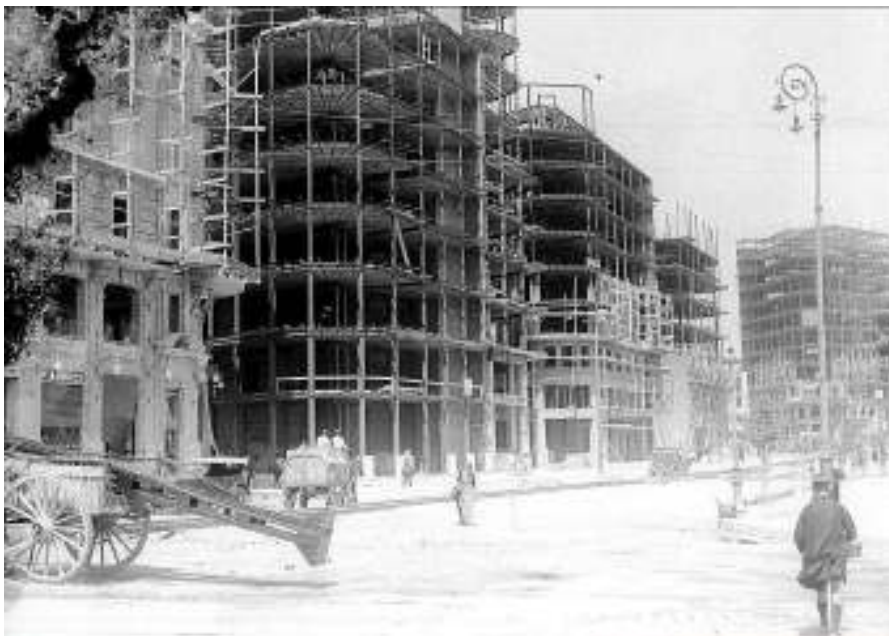
Fig. nº 12.- Vista de construcción de edificio en plaza del Ayuntamiento. Blanco y Negro.
