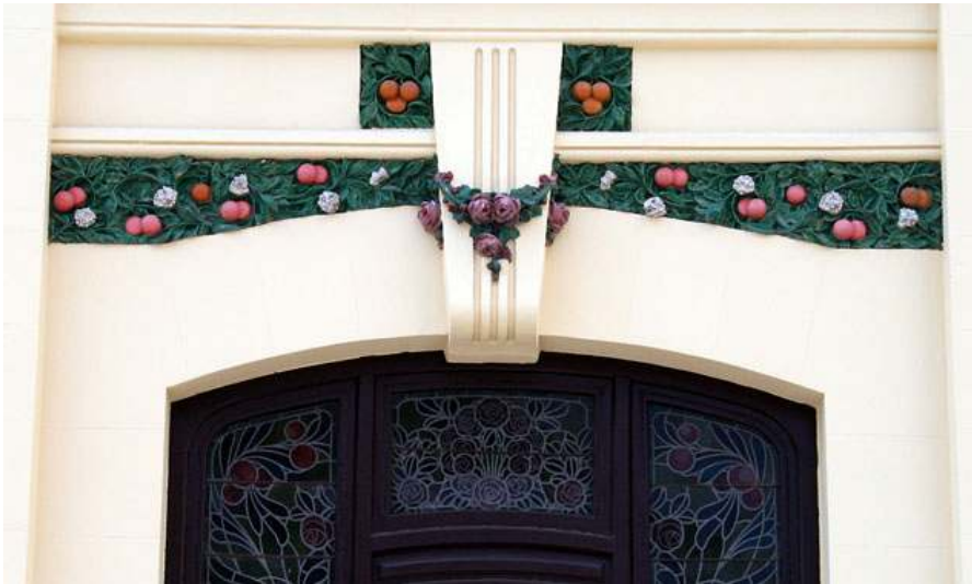
Fig. nº 400.- Detalle decoración claves. Vanos pl. baja f. ppal. E de Valencia. A. propio (2008).
