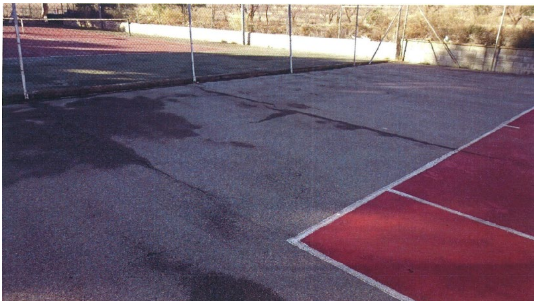
Imatge 6. Lesions en pistes de tennis de formigó drenant
