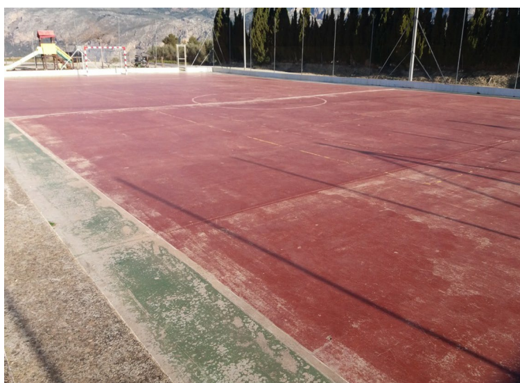
Imatge 8. Paviment de formigó remolinat deteriorat
