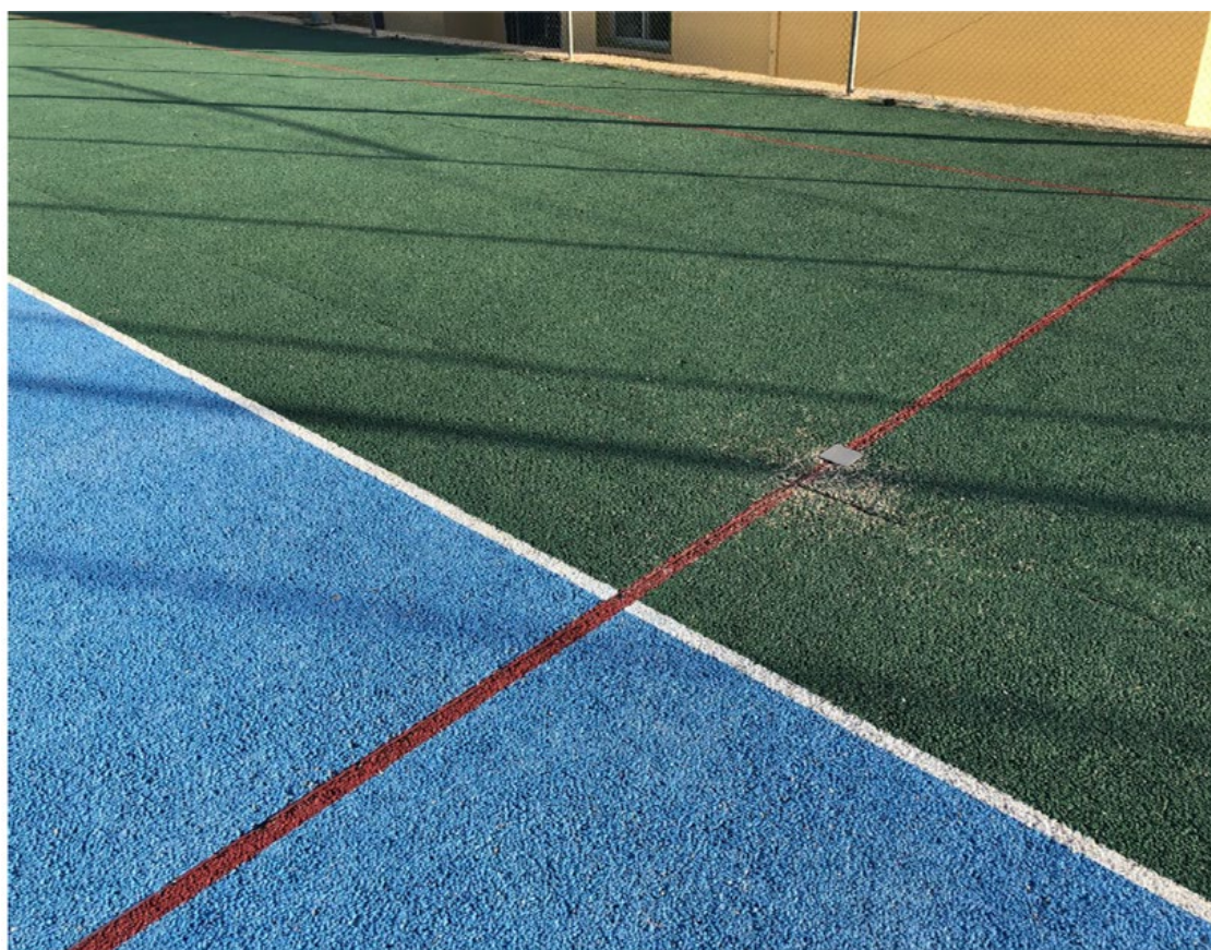
Imatge 3. Lesions en pista de formigó drenant
