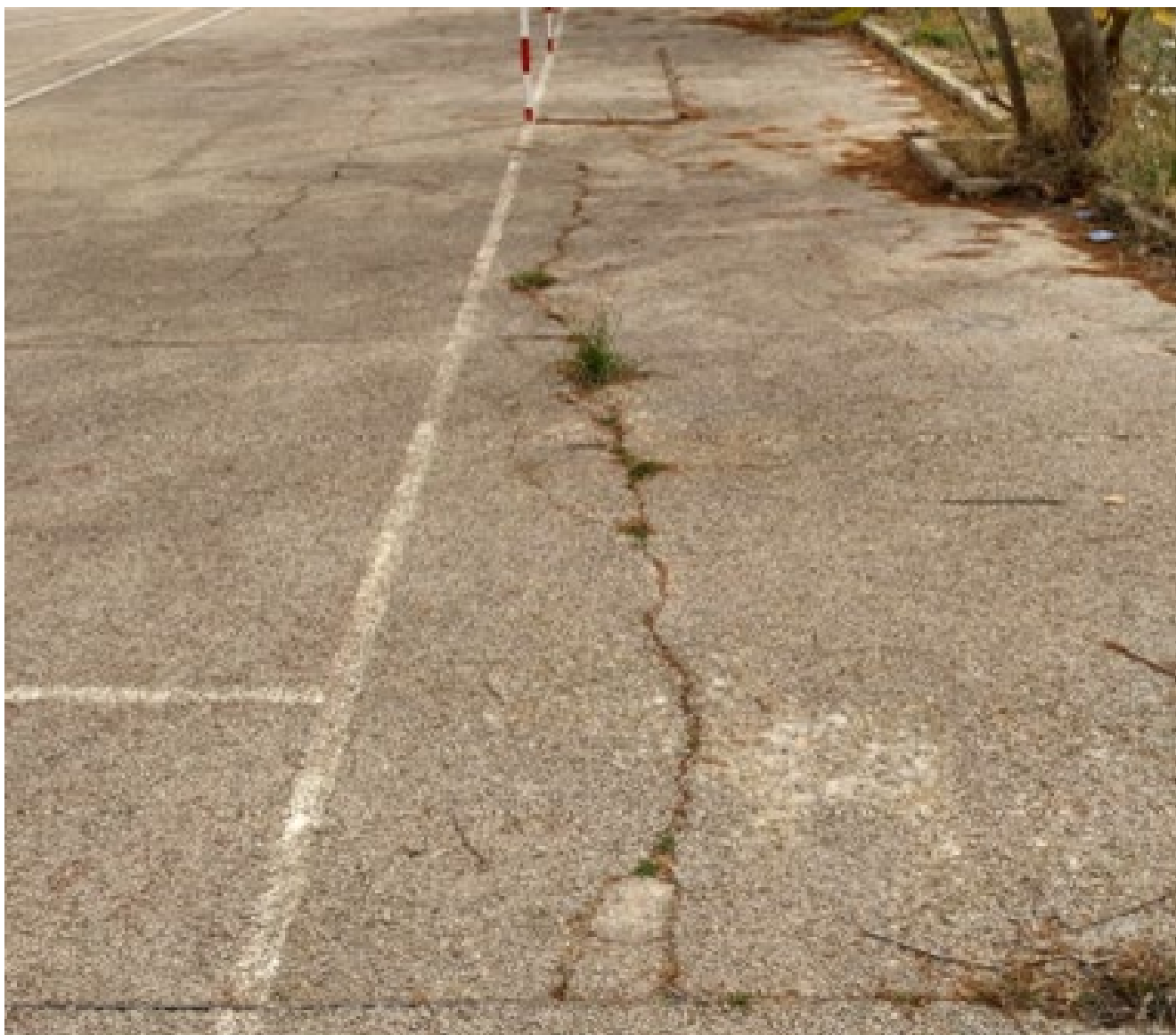
Imatge 4. Lesions en pistes de formigó drenant
