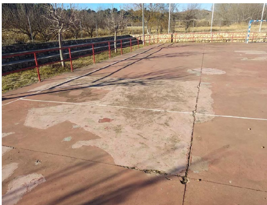
Imatge 12. Paviment de formigó deteriorat
