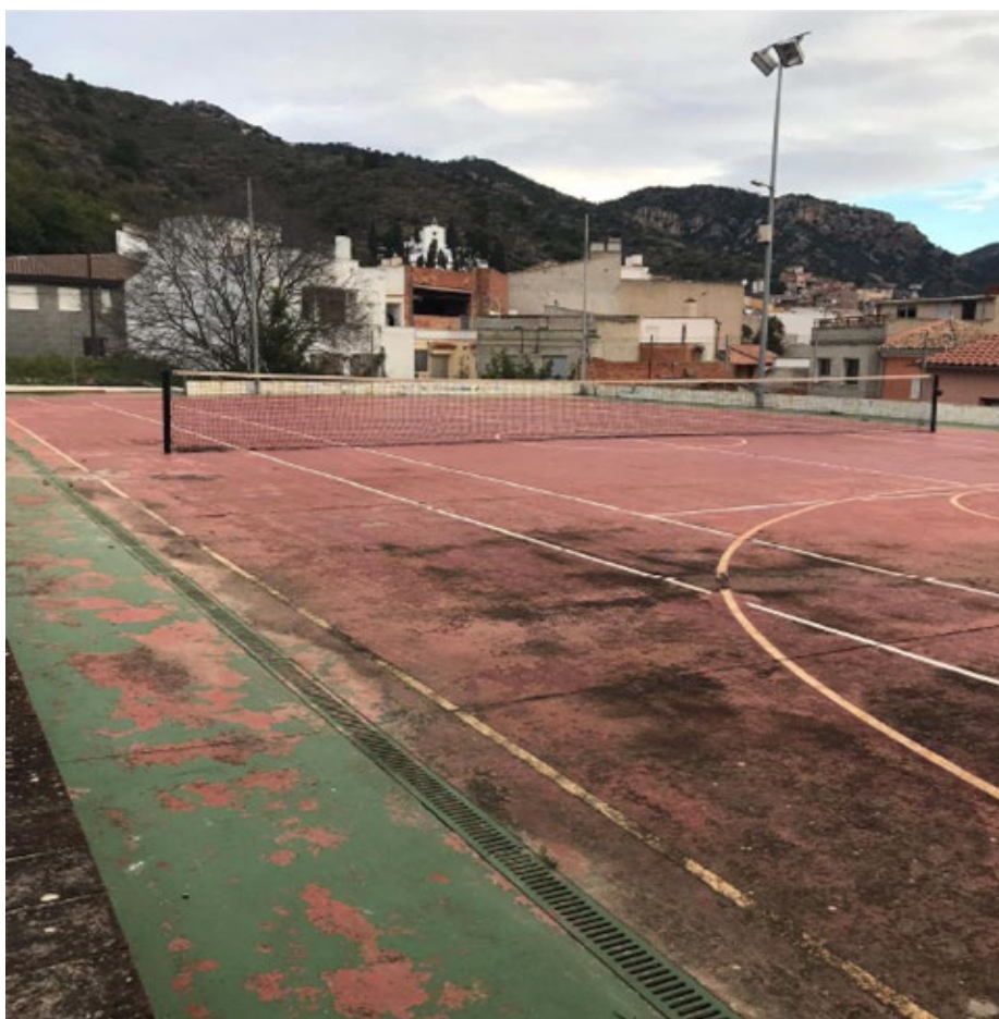
Imatge 13. Pista de tennis deteriorada sobre formigó remolinat
