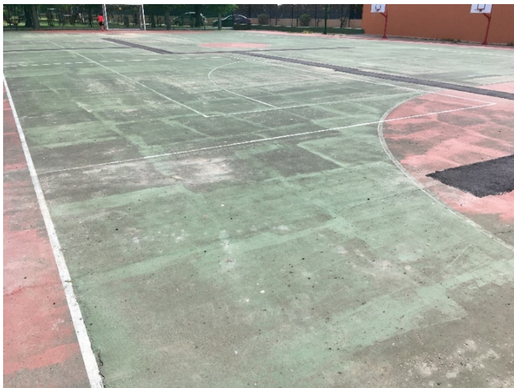
Imatge 18. Paviment asfàltic clevillat
