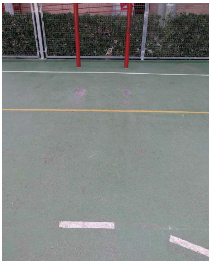
Imatge 2. Lesions en pista de formigó drenant
