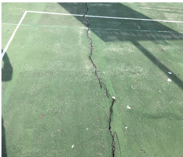
Imatge 19. Paviment asfàltic clevillat
