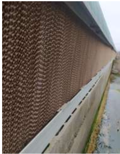
Figura 33 Canal del sistema de cooling
