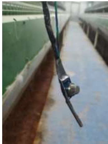
Figura 45 Colocación Sensor de Gases
