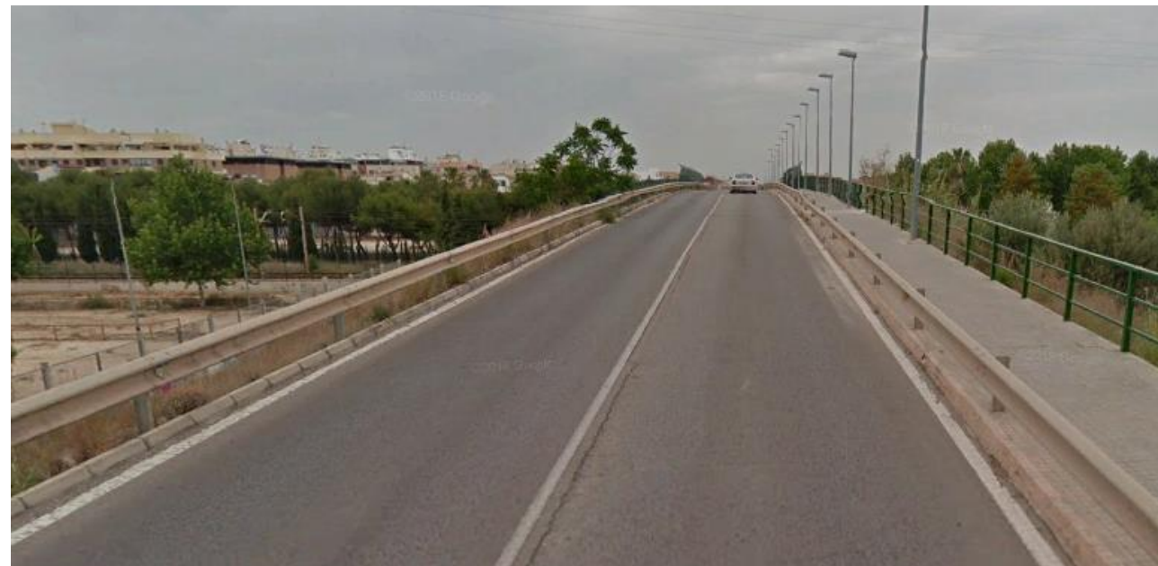
Imagen nº56. Paso elevado situado entre Massanassa y Alfafar con acera situada a la derecha de la imagen.
