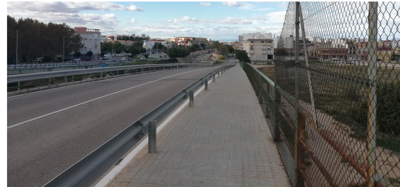
Imagen nº57. Paso elevado en Massanassa con acera situada en la derecha de la imagen. Fuente: Elaboración propia
