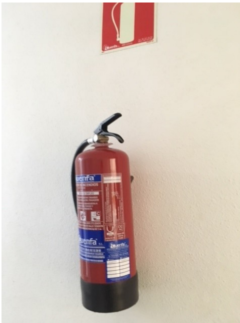
Foto 14 Extintor polvo ABC
