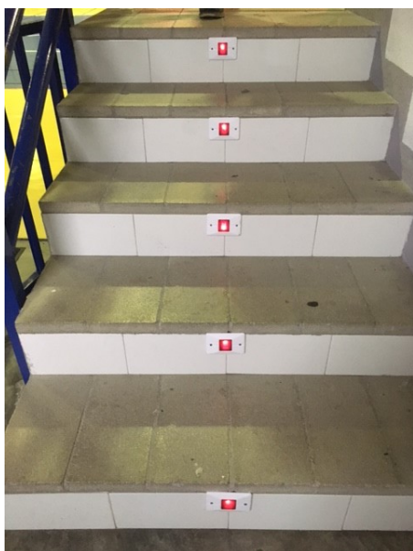
Foto 15 Iluminación emergencia escaleras
