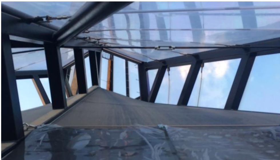
Figura 41. Chimenea solar, vista desde el interior
