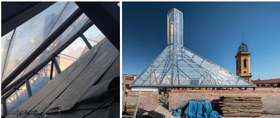
Figura 42 y 43. Chimenea solar, vista desde el interior y exterior
