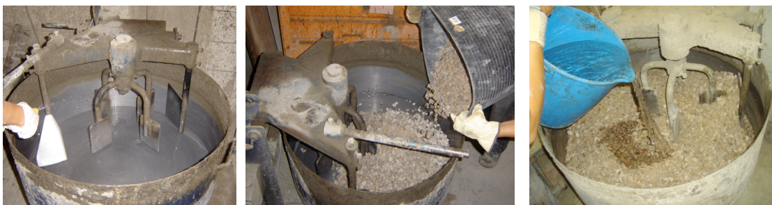
Figura 5.9. Se humedece el tambor de la hormigonera, se añaden los áridos gruesos (de mayor a menor tamaño) y se incorpora \frac{1}{3} el agua. 2 vueltas a la hormigonera para extender los áridos y esperar 30 seg.
