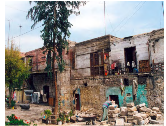
Ilustración nro 67: Patio del Tambo de la Cabezona, Arequipa, antes de la intervención
