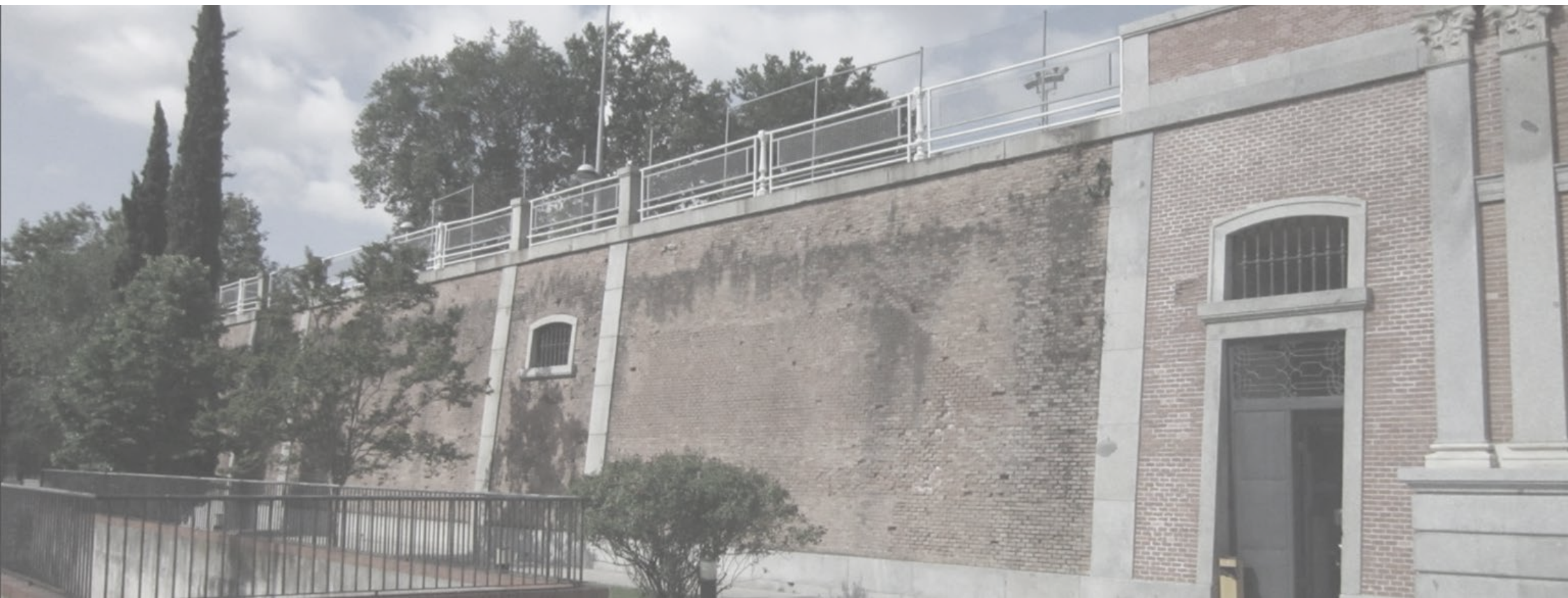
Fig. 32 | Fotografía del estado actual de parte del muro del depósito.
