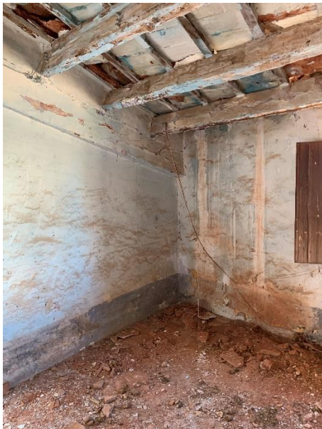
[Fig. 125] Aproximació a taques en el mur. Font: Elaboració pròpia. Betxí. 2020.
