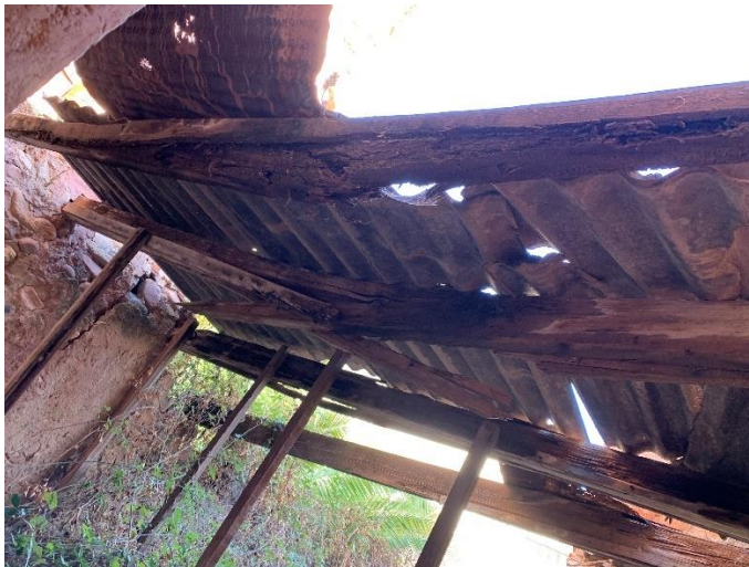
[Fig. 133] Ruptures visibles en el porxe del pati o zona exterior. Font: Elaboració pròpia. Betxí. 2020.
