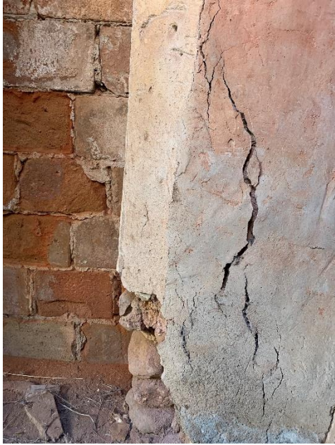
[Fig. 140] Detall de clavill per discontinuïtat en l'aparell. Font: Elaboració pròpia. Betxí. 2020.
