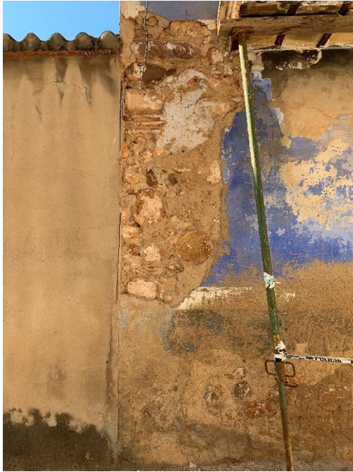
[Fig. 130] Detall de l'encrostonat i caiguda del revestiment. Font: Elaboració pròpia. Betxí. 2020.
