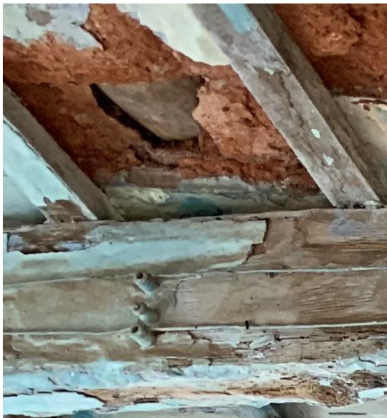
[Fig. 139] Àrea falta de material ceràmic per a l'entabicat de la coberta. Font: Elaboració pròpia. Betxí. 2020.
