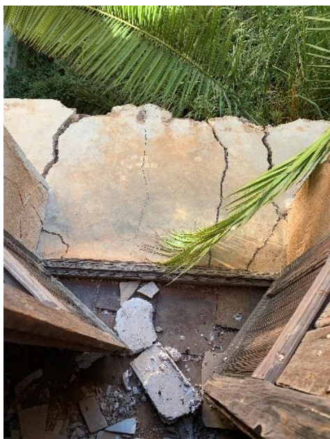
[Fig. 91] Defecte estructural, grietes en el balcó. Font: Elaboració pròpia.
