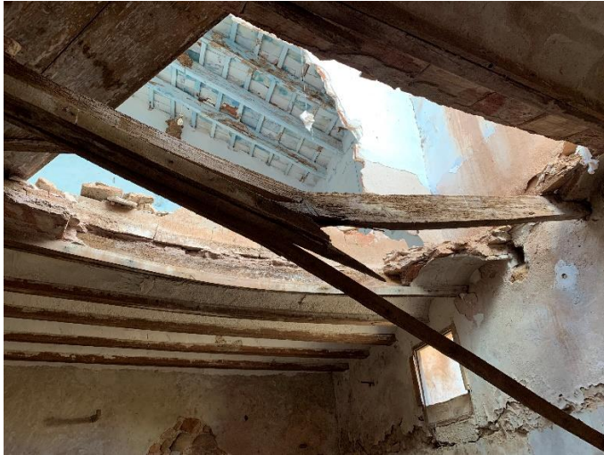
[Fig. 132] Detall de ruptura de bigueta de fusta en el forjat. Font: Elaboració pròpia. Betxí. 2020.
