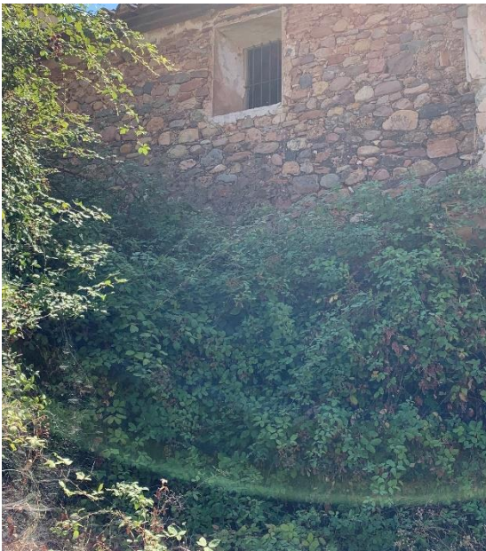
[Fig. 145] Considerable vegetació en les parts baixes de la façana que dóna a la Bassa. Font: Elaboració pròpia. Betxí. 2020.
