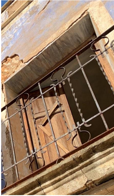
[Fig. 142] Detall de l'oxidació causada en l'estructura metàl·lica del balcó. Font: Elaboració pròpia. Betxí. 2020.
