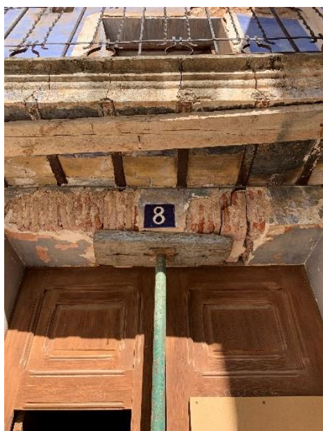
[Fig. 92] Defecte estructural, fletxa en arc de rosca. Font: Elaboració pròpia.
