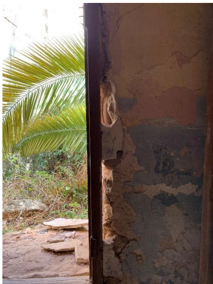
[Fig. 121] Detall d'una erosió en el material del mur. Betxí. Font: Elaboració pròpia. 2020.
