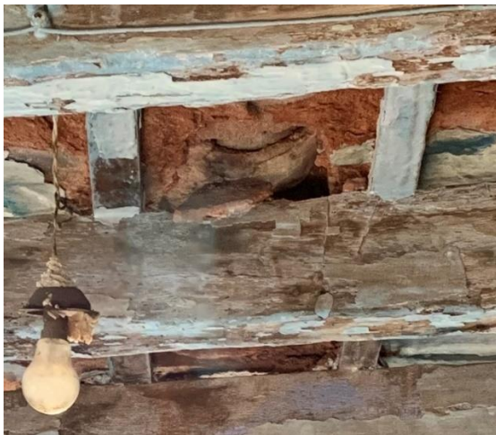
[Fig. 138] Detall de carencia d'entabicat en la coberta inclinada. Font: Elaboració pròpia. Betxí. 2020.
