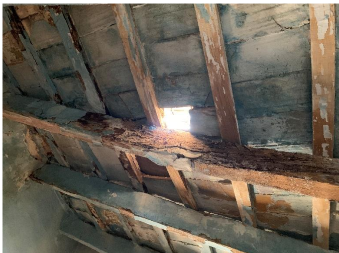
[Fig. 135] Detall de gotera en la coberta de l'edifici. Font: Elaboració pròpia. Betxí. 2020.
