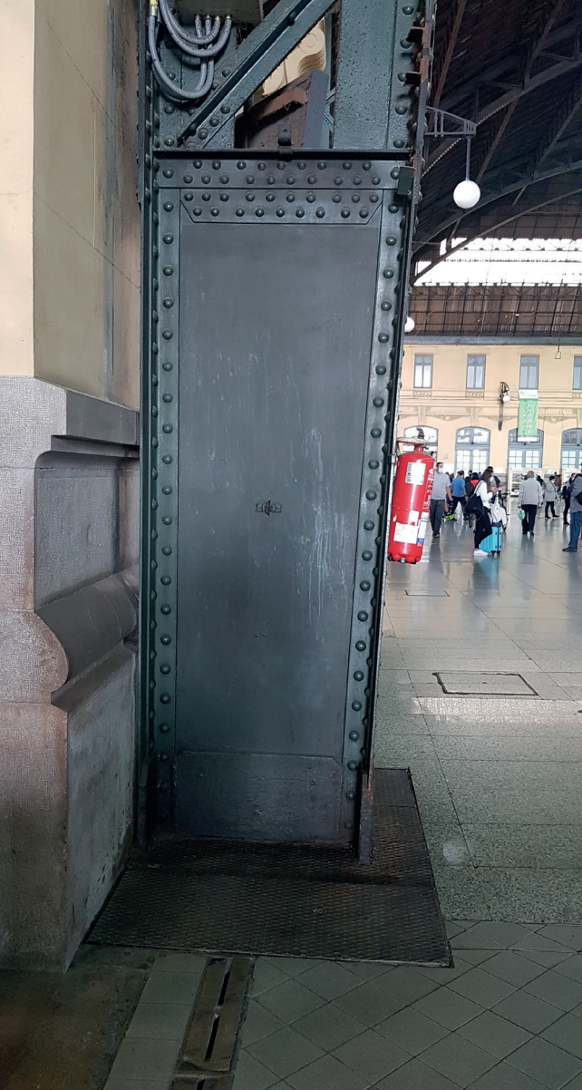
Figura 103: Estado actual encuentro “soporte”- pavimento Fuente: Imagen propia
