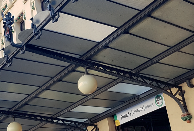
Figura 106: Estado actual marquesina exterior Fuente: Imágen propia
