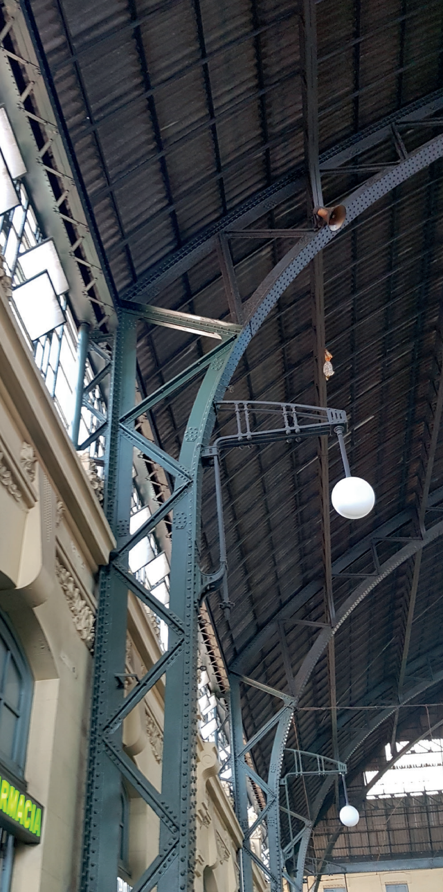
Figura 101: Estado actual encuentro arco-cerramiento Fuente: Imagen propia
