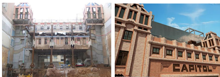
Fig. 80: 01 Intervención en el cine Capitol en 2006. 02 Fachada del Cine Capitol tras la intervención
