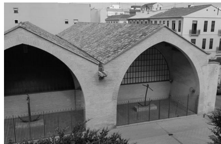
Figura 2.13_Vista superior del edificio: Cubierta compuesta por correas de madera, tableros de ladrillos y tejas árabes.
