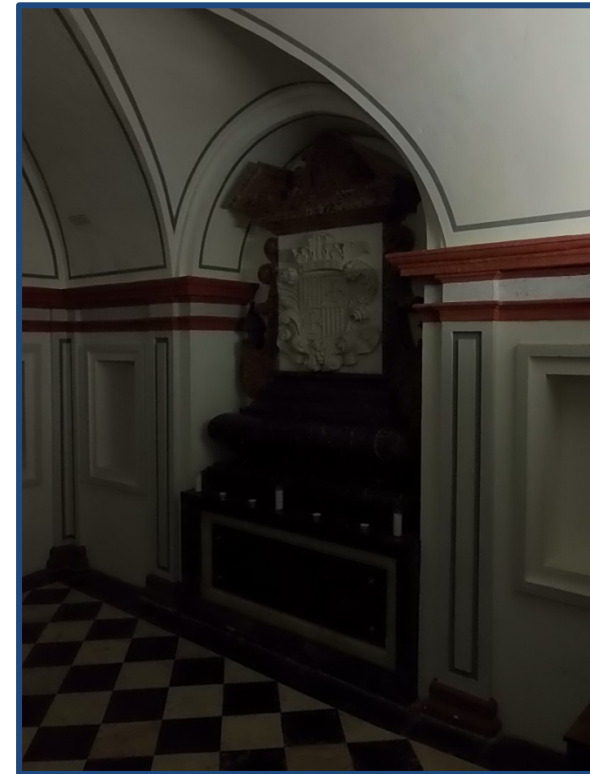
Figura 3.106- Mausoleo del Duque de Calabria en la cripta de los Reyes del Monasterio de San Miguel de los Reyes de Valencia. (2014)
