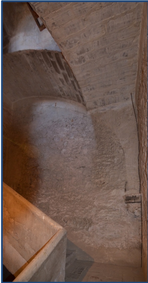
Figura 4.54.- Vista de la escalera de acceso a la cubierta del campanario, y que conecta con distintas estancias utilizadas actualmente como almacén. (2016)
