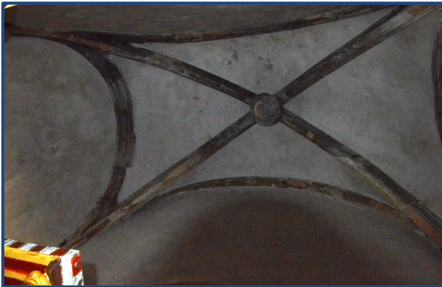
Figura 4.52- Vista de la cubierta mediante bóveda de crucería de la capilla de tránsito al antiguo “fosar”. En la clave está representado un escudo nobiliario. (2016)
