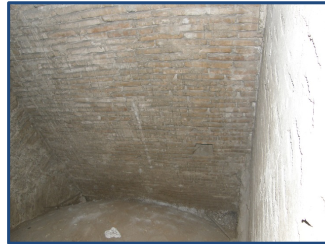
Figura 5.112 y 5.113. Arriba vista desde el interior de la cubierta de la capilla de la iglesia, cobertura superior. Abajo, extradós de la cubierta de la capilla de la iglesia y arranque de la bóveda desde el muro de ladrillo. (2013)
