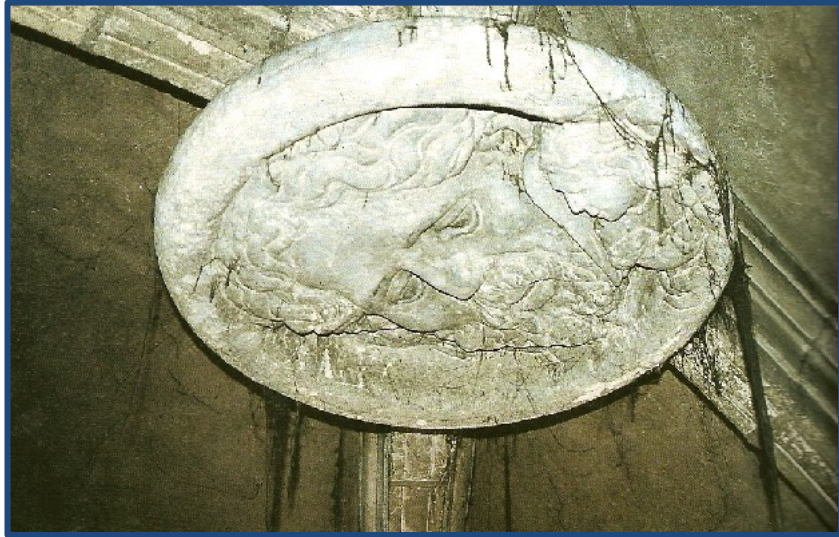
Figura 4.48.- Detalle de la clave de la Bóveda estrellada de la capilla de San Antonio Abad, (hoy bajo la decoración barroca), con la representación de San Mateo y el infante alado. Imagen de: (Daràs Mahiques, 2013)
