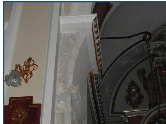
Figura 5.35.- Fotografía de la moldura templo siglo XVI, y arranque del arco de medio punto, que han quedado vistas tras unas obras en los años '80 (2013)
