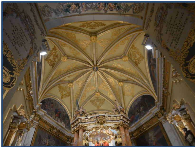
Figura 4.46.- Bóveda estrellada (restaurada) de la capilla de la “ Mare de Deu del Roser ”. (2016)
