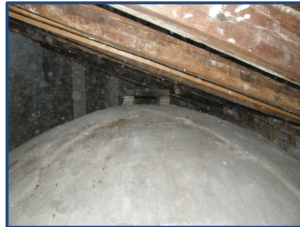
Figura 5.108 y 5.109. Arriba vista desde el interior de la cubierta de la Capilla de la Comunión, con la ventana desde donde podemos ver la bóveda de una de las capillas de la iglesia. Abajo, extradós de la cúpula de la bóveda de la capilla de la comunión. (2013)
