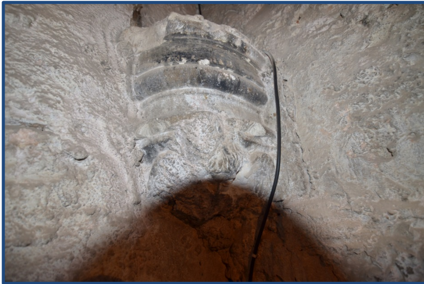
Figura 4.33.- Soporte gótico, que podemos encontrar en las escaleras del campanario. Evidencia del primer templo realizado en el siglo XV. Vemos un reaprovechamiento de las partes construidas anteriormente. (2016)
