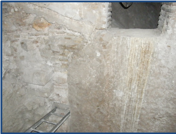
Figura 5.106 y 5.107. Arriba vista del extradós de la bóveda de cañón que cubre el acceso a la capilla de la comunión, donde vemos un apeo reciente sobre la bóveda. Abajo ventana de acceso al interior de la cubierta de la capilla de la comunión. (2013)
