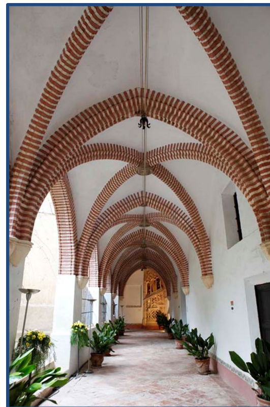
Figura 3.43.- Claustro del Monasterio de San Jerónimo de Cotalba, con las arcadas con ladrillos de color rojo y blanco. (2013)
