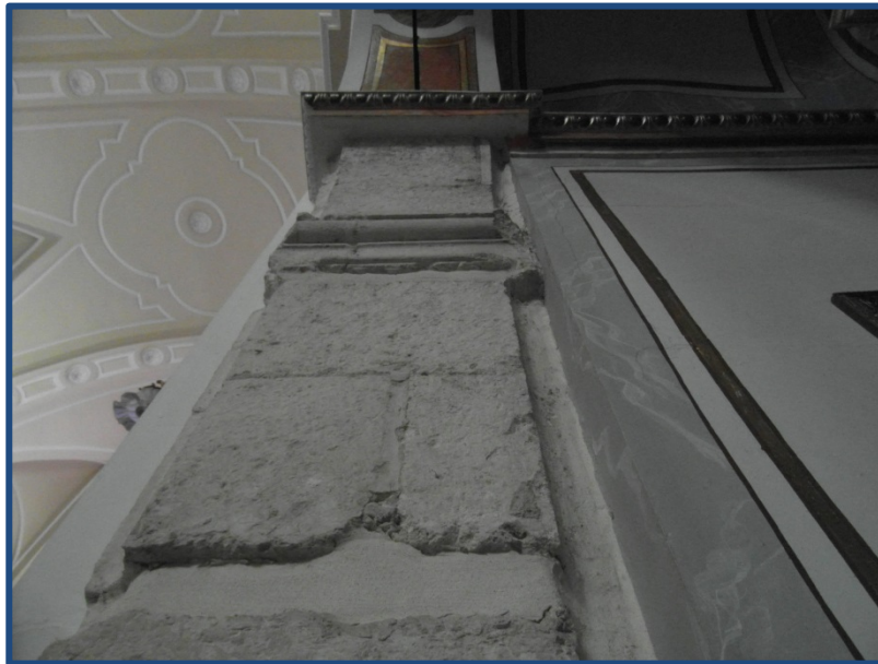
Figura 5.54- Soporte del que hemos tomado la muestra para analizar químicamente, en concreto en la parte interior del soporte (derecha) (2013)
