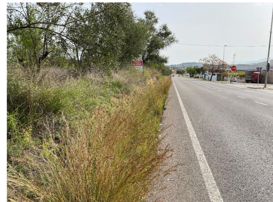
FIGURA 54. ESTADO ACTUAL CUNETA (FUENTE: PROPIA)
