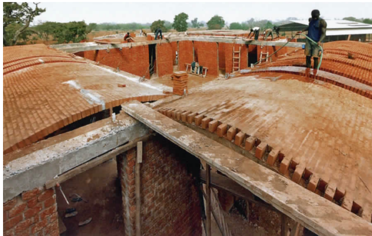
Fig. 18. Imagen del proceso constructivo. Fuente: Baan, Iwan y Keré Architecture. AV Monografías 201 .
