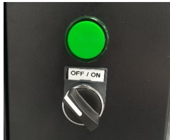
FIGURA 12. INTERRUPTOR SELECTOR MODO SEGURIDAD
