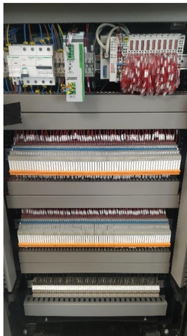
FIGURA 7. CARA FRONTAL DEL ARMARIO ABIERTO
