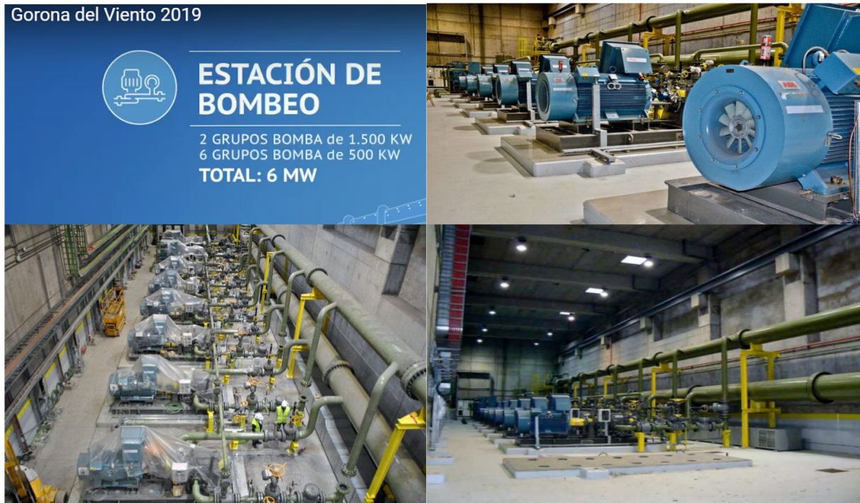
Imagen 4.2.1.3_01: Características de la estación de bombeo
