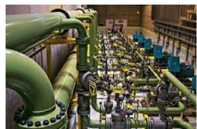
Imagen 4.2.1_03: Estación de bombeo
